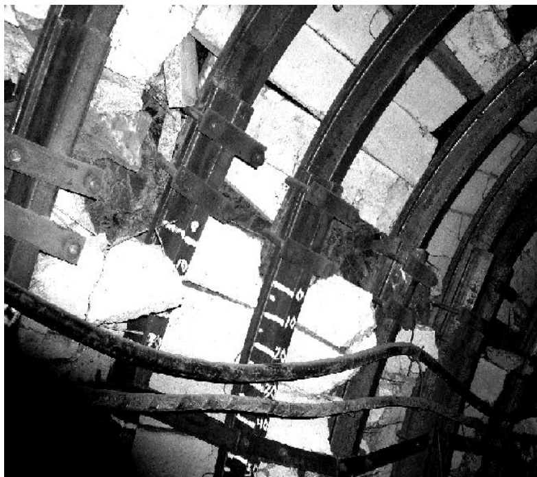
Рисунок 1 – Деформации железобетонных затяжек
