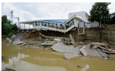
2017年7月九州北部豪雨災害、河岸浸食により破壊された比良松中学校 (竹林洋史准教授提供)
