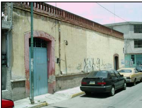
Fig. 79 Edificio deteriorado. Foto: del autor.
