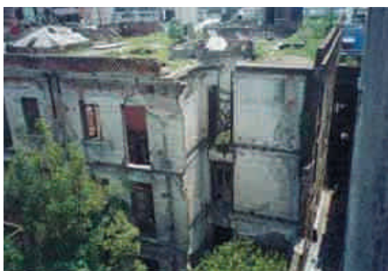
Dr. Vértiz núm. 25, colonia Doctores (antes de la rehabilitación) Foto: Invi, 2002.
