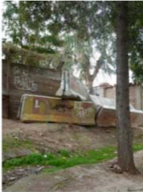
2. RUPTURA DEL BORDE
