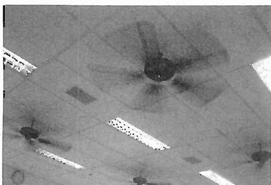
写真5 億載小学校の教室 空気の循環を促すファン
