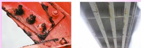
長崎県内橋梁の塩害による被害
