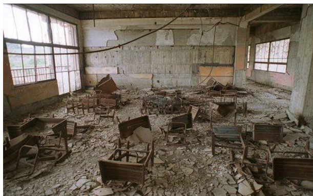
図7 被災した校舎内の教室
