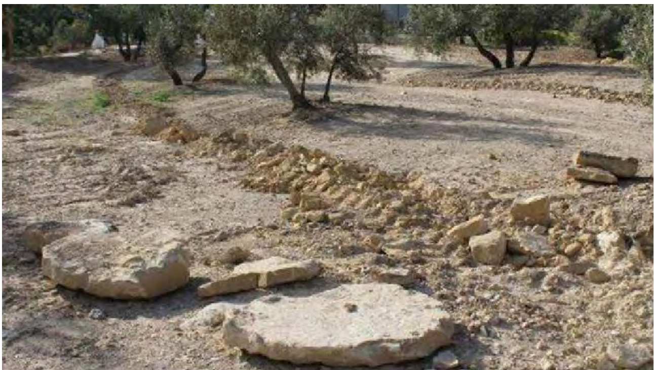
Fig. 22. Losas levantadas por la instalación de la infraestructura de riego en «Cerro Maquiz» en 2017. Fuente: Universidad de Jaén.
