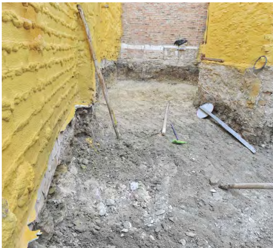
Fig. 396. Vaciado tras intervención en calle Alharilla 2. Obsérvese la zona blanqueada por los restos de un muro de cal destruido por el destierro.
