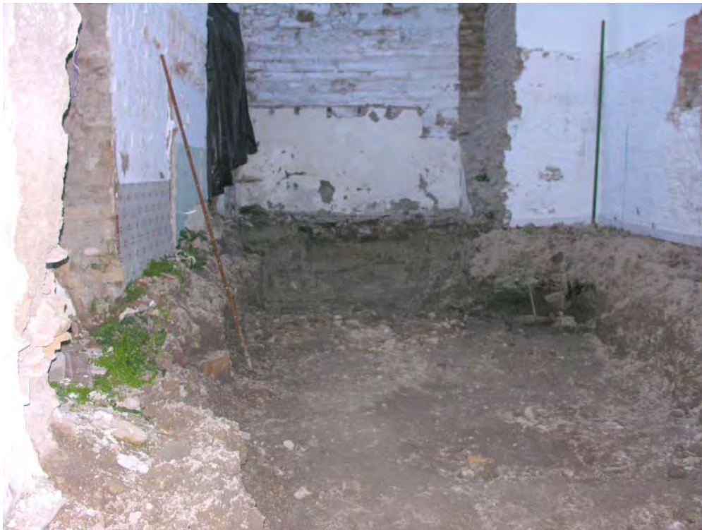
Fig. 374. Seguimiento con pala excavadora en Alférez Manuel Casado, 24. Fuente: Fototeca de ARQUIPO. Sign.: FD-2006-02-07-059.
