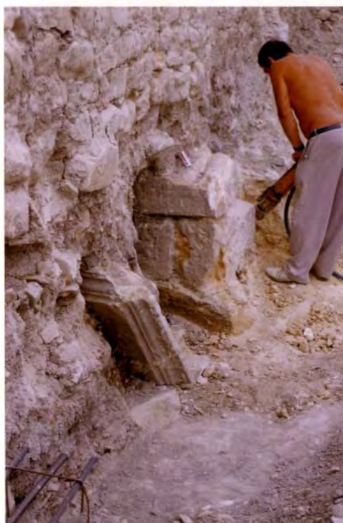
Fig. 334. Destrucción de estructuras romanas en la obra de la calle Alférez José Morente, 6. Fuente: Fototeca de ARQUIPO. Sign.: APR-040.
