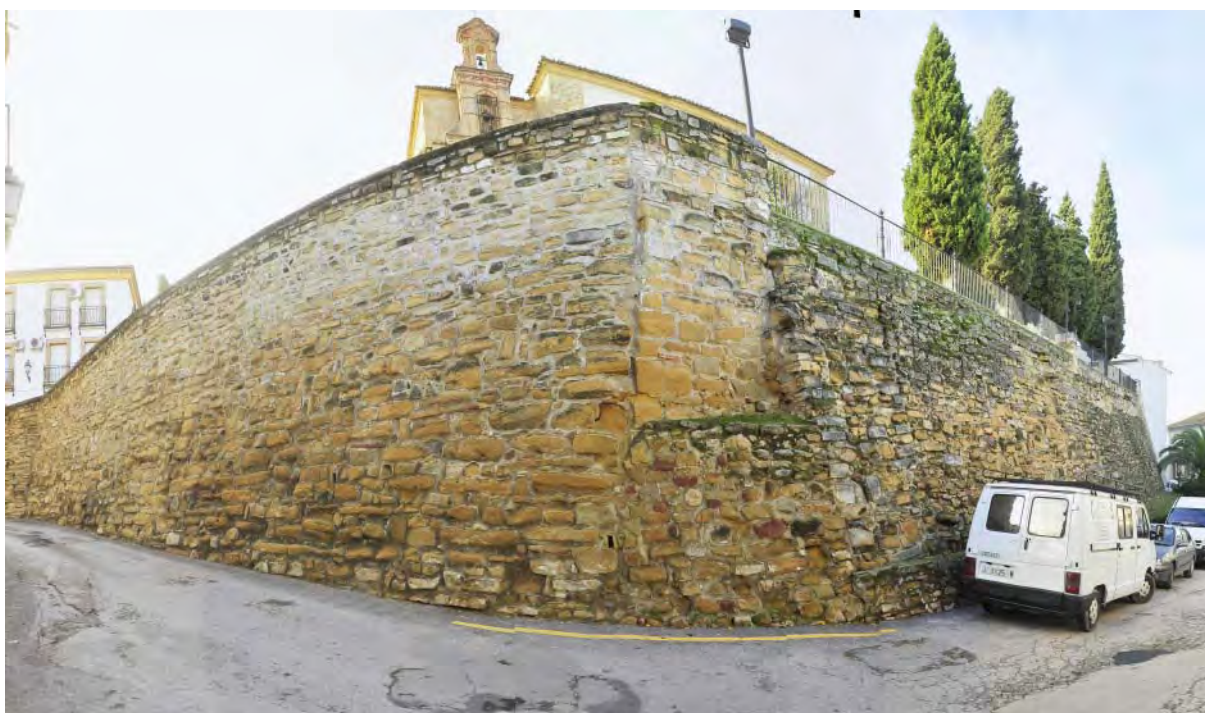
Fig. 476. Gran muro de contención norte del Santuario de los Santos. Fuente: Fototeca de ARQUIPO. Sign.: Pan-2016-12-17-ND700-047-053.
