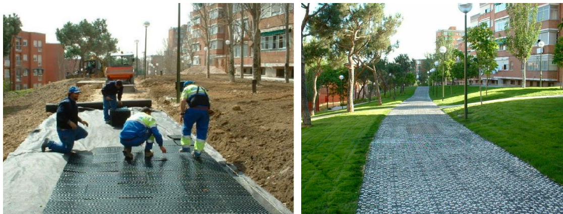
Fig.2 - Posa in opera dei sistemi di drenaggio per il deflusso delle acque (Source: SUDS-ATLANTIS)
