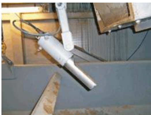
Ilustración 5 Sensor humedad bajo cuba Hidronix, (2020)
