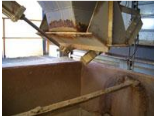
Ilustración 4 Sensor de humedad bajo cuba de áridos Hidronix (2020)
