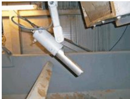
Ilustración 5 Sensor humedad bajo cuba Hidronix, (2020)
