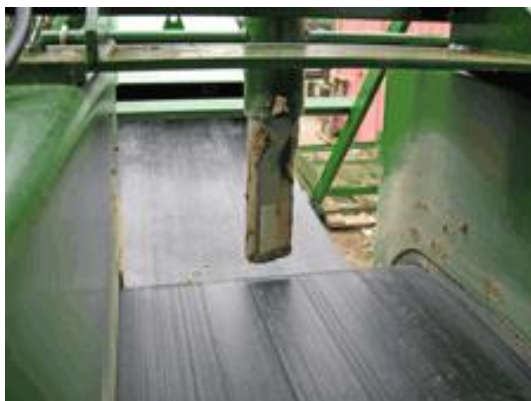
Ilustración 3 Sensor sobre cinta transportadora de arena Hidronix (2020)
