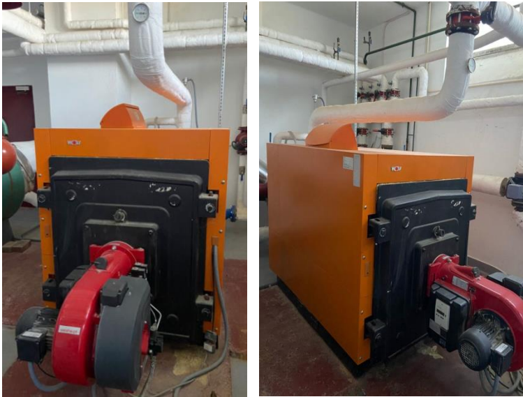
Imagen XV y XVI- Caldera del edificio
