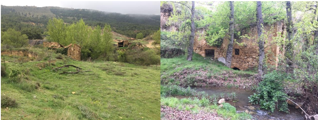
Figura 55. Molino bajo (izq) y alto (dcha) en ruinas. Fuente. Alfredo Ollero
