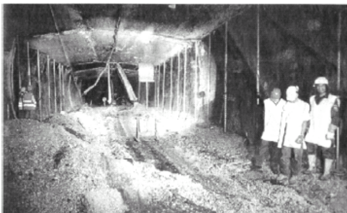
Figure 38: Exemple d'écaillage. Après l'incendie dans le tunnel de Tauern (source [110])
