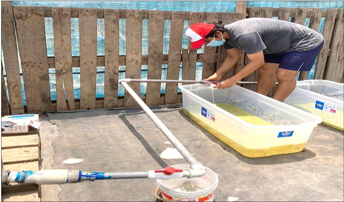
Figura 31. Conexión de tuberías del sistema de fitodepuración
