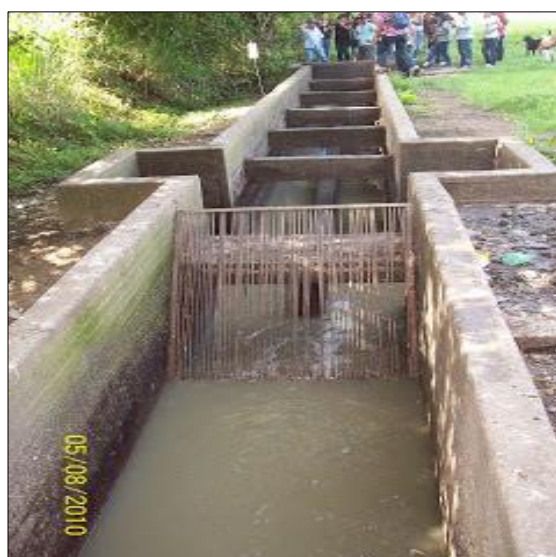
Figura 4. Cámara de rejas en plantas de tratamiento (Anónimo, 2010)
