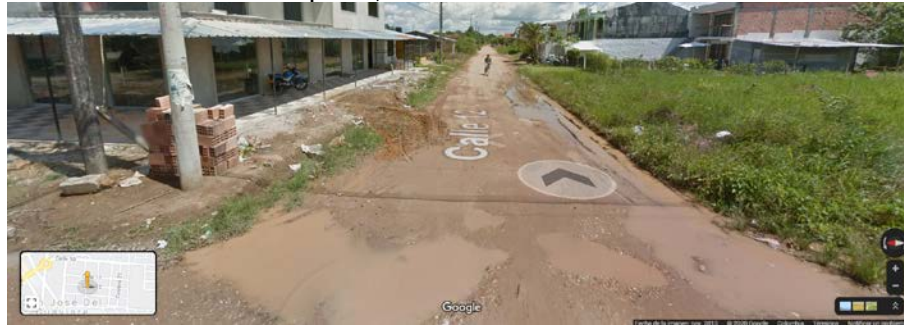
Figura 4-12: Tramo vial en destapado, calle 12 con carrera 26.
