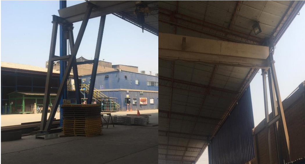
Figura 18: Puente grúa estático
