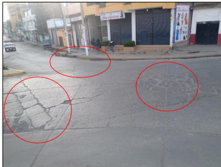
Figura 74. Capa asfáltica con grietas estructurales
