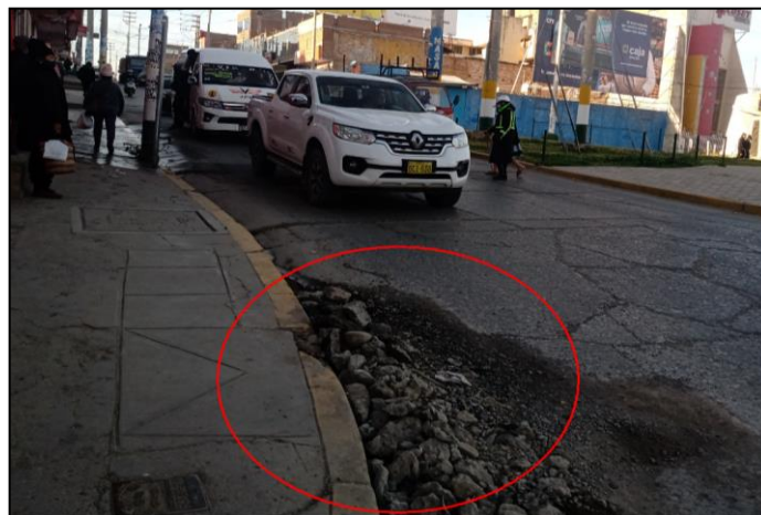
Figura 8. Calles sin mantenimiento en el Óvalo Huancavelica
