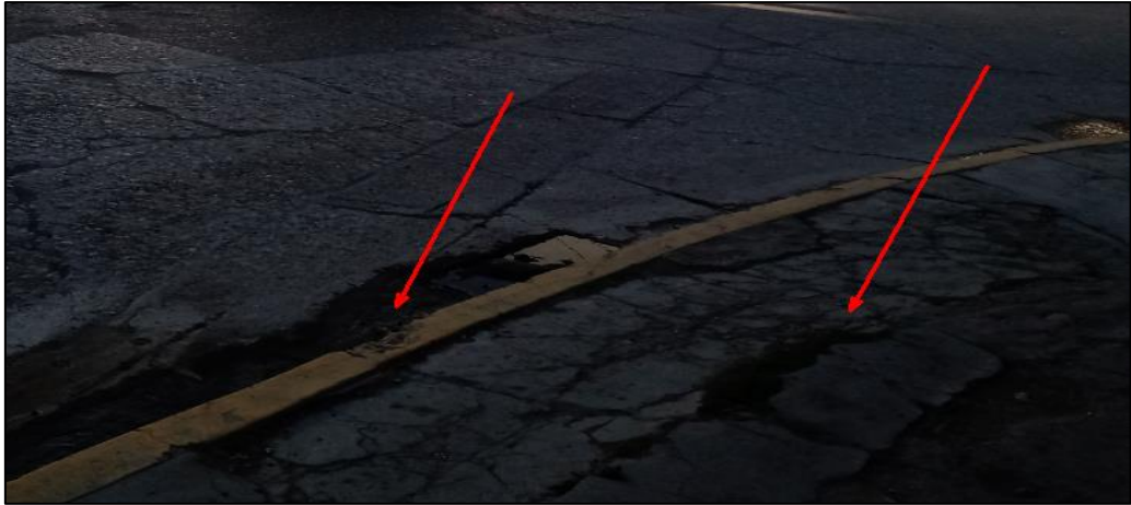
Figura 71. Acera en mal estado en la Av. Huancavelica y Julio Sumar
