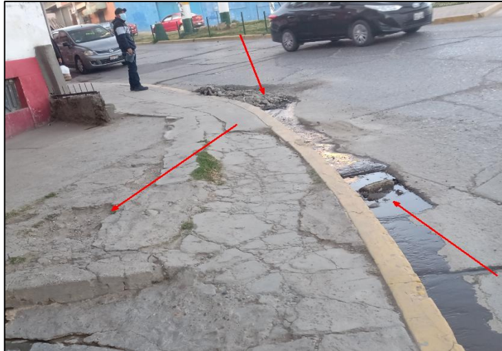
Figura 73. Problemas en las aceras y cunetas en la Av. Huancavelica
