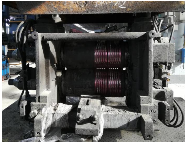
Figura 51 Antes - Caseta de Laminación sin guías
