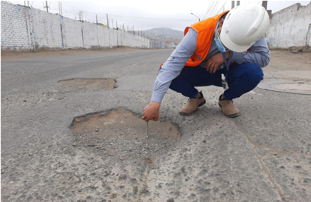
Identificación y medición de falla a lo largo de la calzada.
