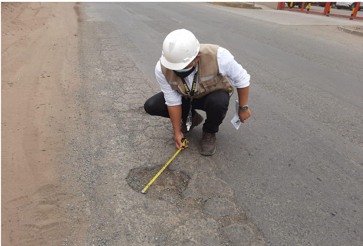
Identificación y medición de falla a lo largo de la calzada.
