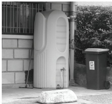
Figure 1 – Une cuve de récupération des eaux de pluie installée par le Conseil Général du Val-de-Marne
