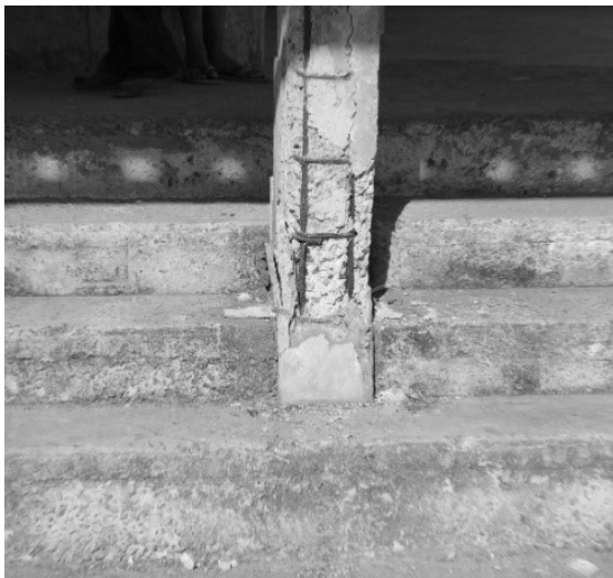
Foto 4. Deficiente separación de estribo. Fuente: autores
