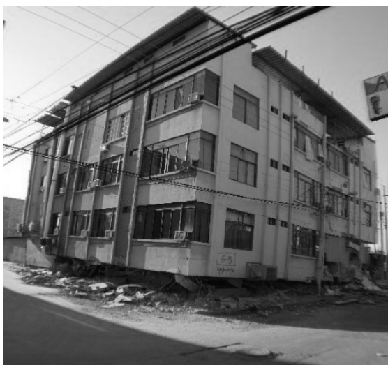
Foto 6. Ejemplo clásico de piso blando. Fuente: autores
