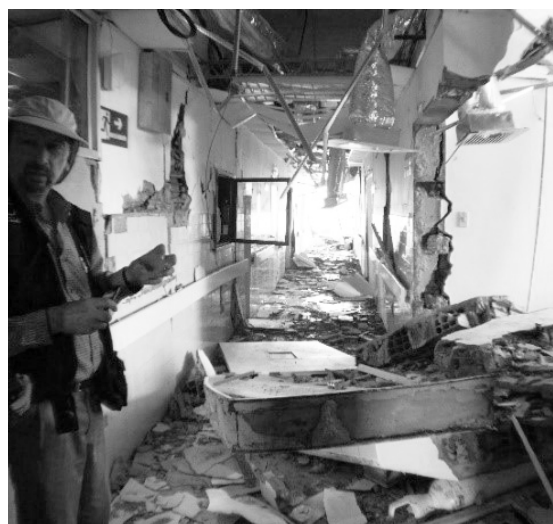
Foto 3. Hospital IESS de Manta internamente. Se visualiza daño en mampostería Fuente: autores
