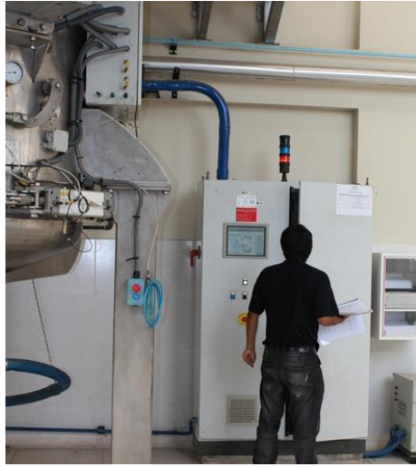
Figura N° 29: Panel de Control Fuente: Hospital Hipólito U. – Lima
