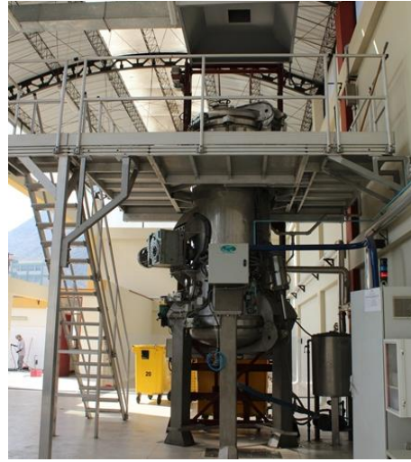
Figura N° 30: Máquina Trituradora Fuente: Hospital Hipólito U. – Lima
