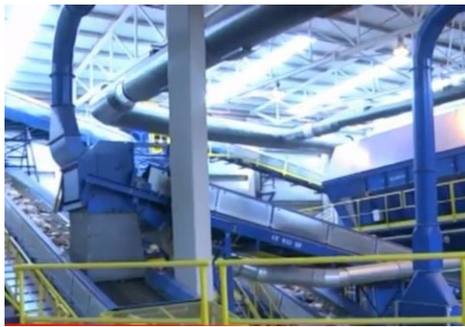
Figura N° 66: Sala de Máquinas Fuente: Bizkaia
