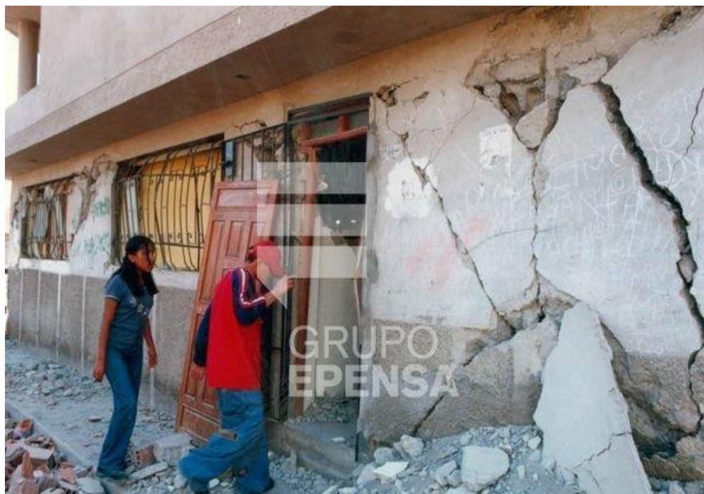
Figura N°05: así quedó la vivienda en ciudad nueva distrito que fue muy afectado (fuente: diario correo)
