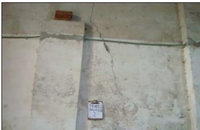
FIGURA 21. Fallas por asentamiento en muros
