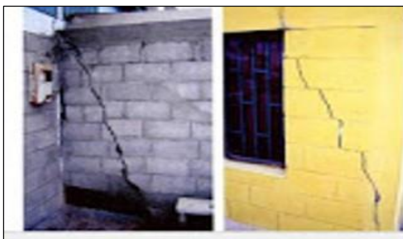
FIGURA 22. Fallas por sismo en muros
