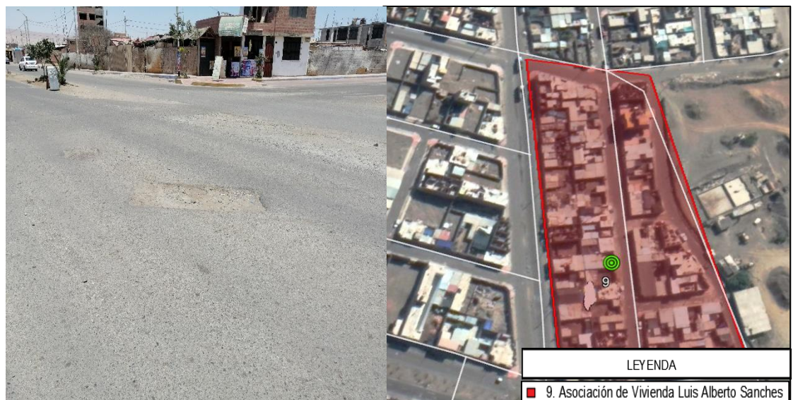
FIGURA 71. Presencia de fallas por desgaste en la vía y ubicación satelital
