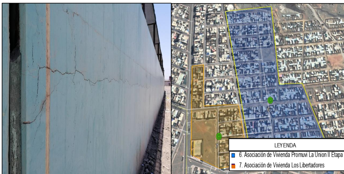
FIGURA 75. Presencia de fallas en el muro en la zona y ubicación satelital
