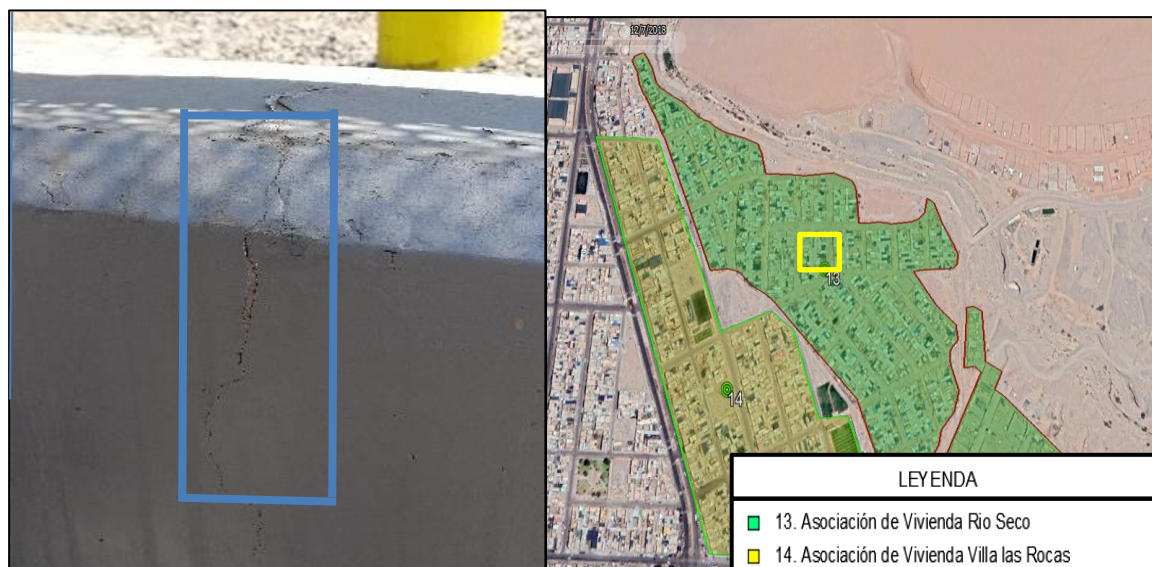
FIGURA 65. Presencia de fallas estructurales en la obra y ubicación satelital
