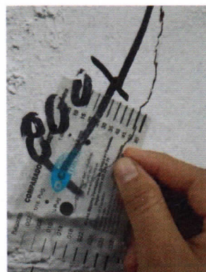
Foto 111. Espesor de grieta de 0.5mm en ladrillo de la cara Norte y Sur para una distorsión de 1/550.
