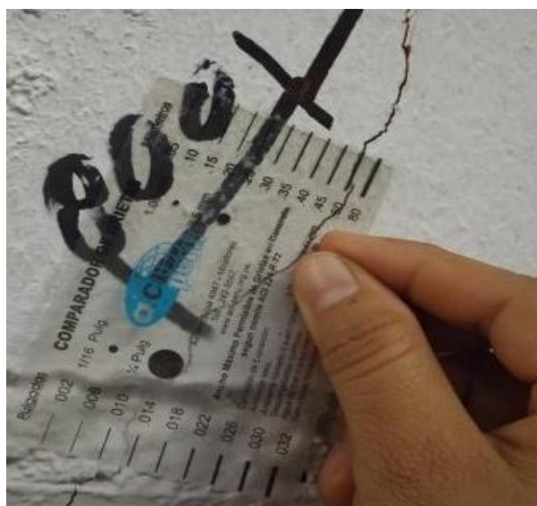
Figura N°4.13: Mapeo de fisuras para una distorsión de 1/550.
