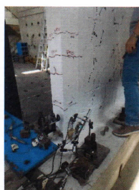
Foto 65. Formación de grietas diagonales en la parte inferior Este de la cara Norte para una distorsión de 1/400.
