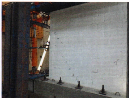
Foto 37. Formación de grietas diagonales en el mortero hasta antes de la parte central en la parte superior e inferior Oeste de la cara Sur para una distorsión 1/1500.
