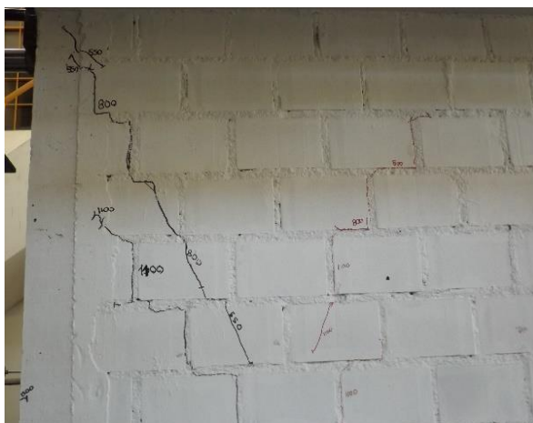
Figura N°4.12: Mapeo de fisuras para una distorsión de 1/550.
