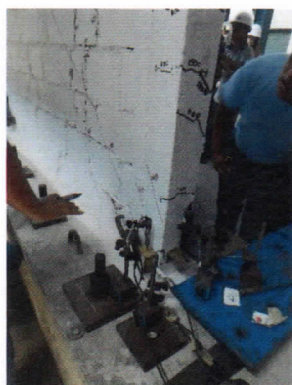
Foto 66. Formación de grietas diagonales en la parte inferior Este de la cara Sur para una distorsión de 1/400.
