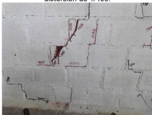
Foto 70. Desprendimiento de ladrillo en la zona central inferior de la cara Sur para una distorsión de 1/400 en el 2º ciclo.
