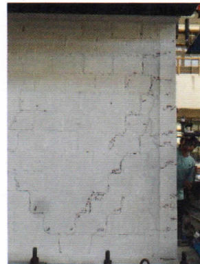
Foto 110. Continuación de grietas en el ladrillo y en el mortero en las caras Norte y Sur para una distorsión de 1/800.
