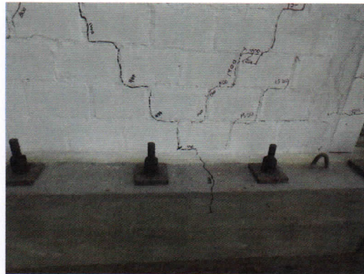
Foto 114. Aparición de grieta en la base de la cara Sur para una distorsión 1/550.
