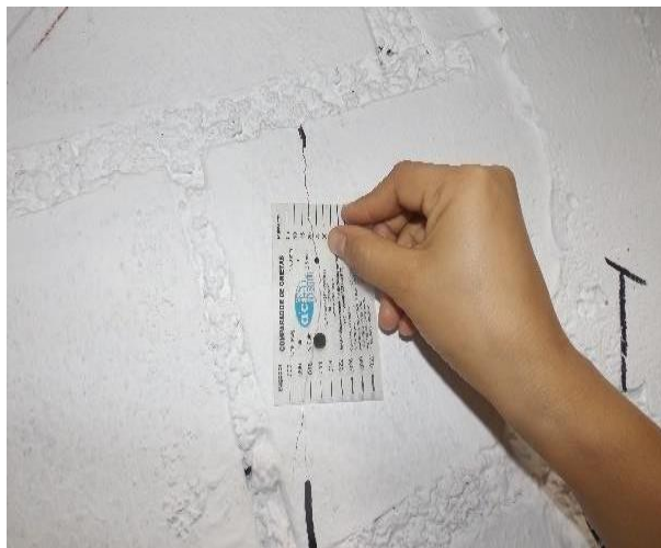
Figura N°4.6. Medición de las grietas para una distorsión de 1/1100.
