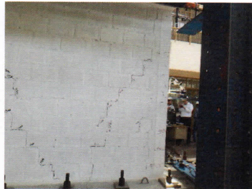
Foto 49. Formación de grietas por flexión en la parte inferior de la columna Este para una distorsión de 1/1100.
