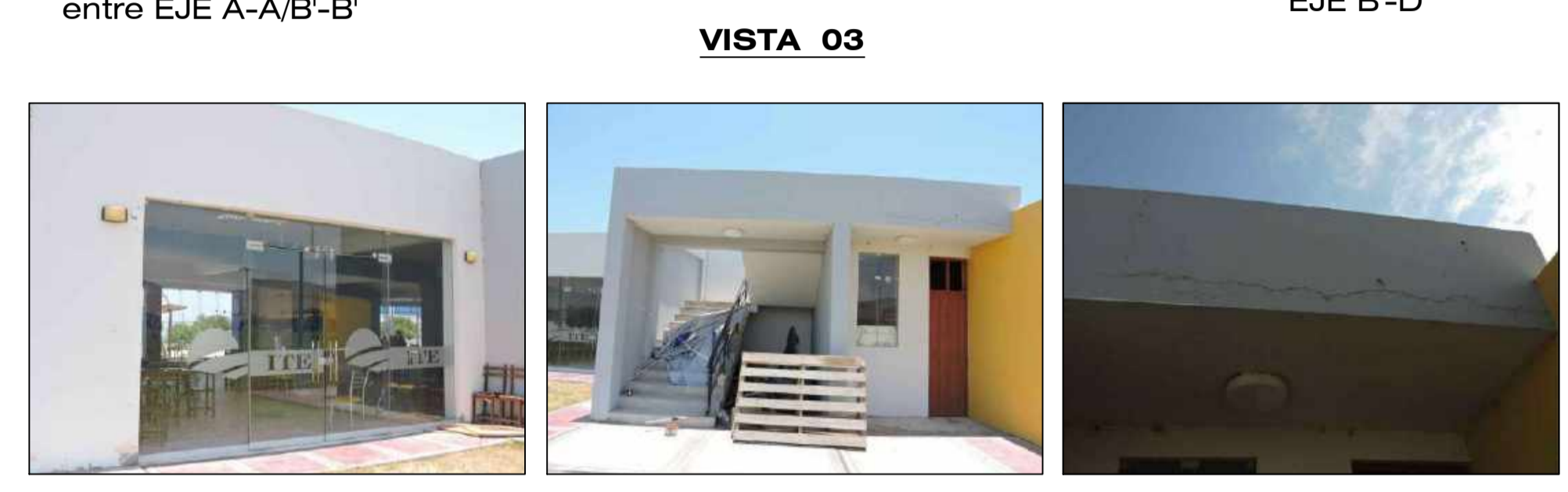
Fisuras longitudinales y transversales en el portico y área de escalera ubicados en los EJES 1-1/2-2 entre EJE D-D'/F-F'
