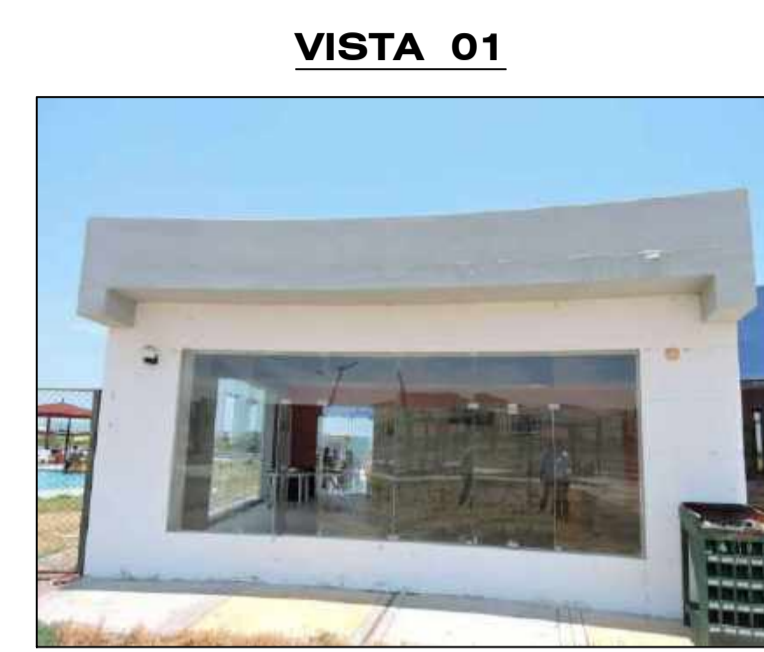
VISTA 01 Fisuras longitudinales y transversales de la parte exterior del salón de juegos en el EJE 5-5 entre EJE A-B'
