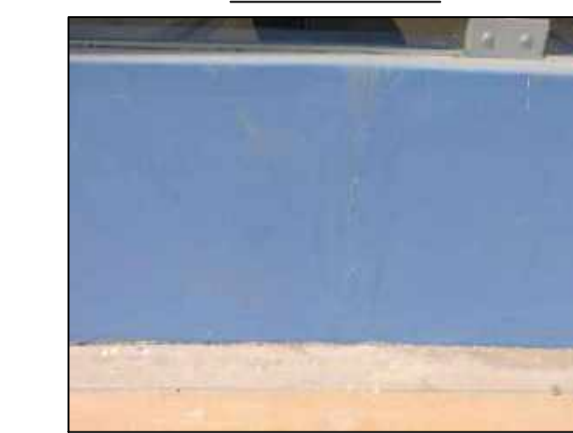
Fisura transversal en el sobrecimiento parte externa EJE 5-5 entre EJE A-B
