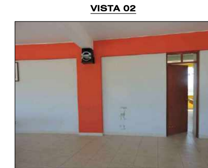
Humedad en la pared en el EJE 3-3 entre EJE C-D
