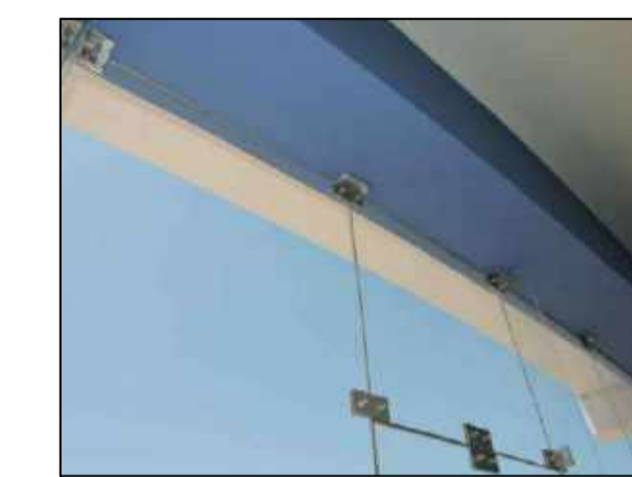
Fisura longitudinal en la viga EJE 5-5 entre EJE A-B
