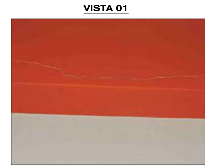
Fisura longitudinal inferior en la viga EJE 3-3 entre EJE E-F
