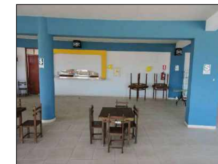
Fisuras longitudinales y transversales en el portico ubicado en el EJE 2-2 entre EJE B-C
