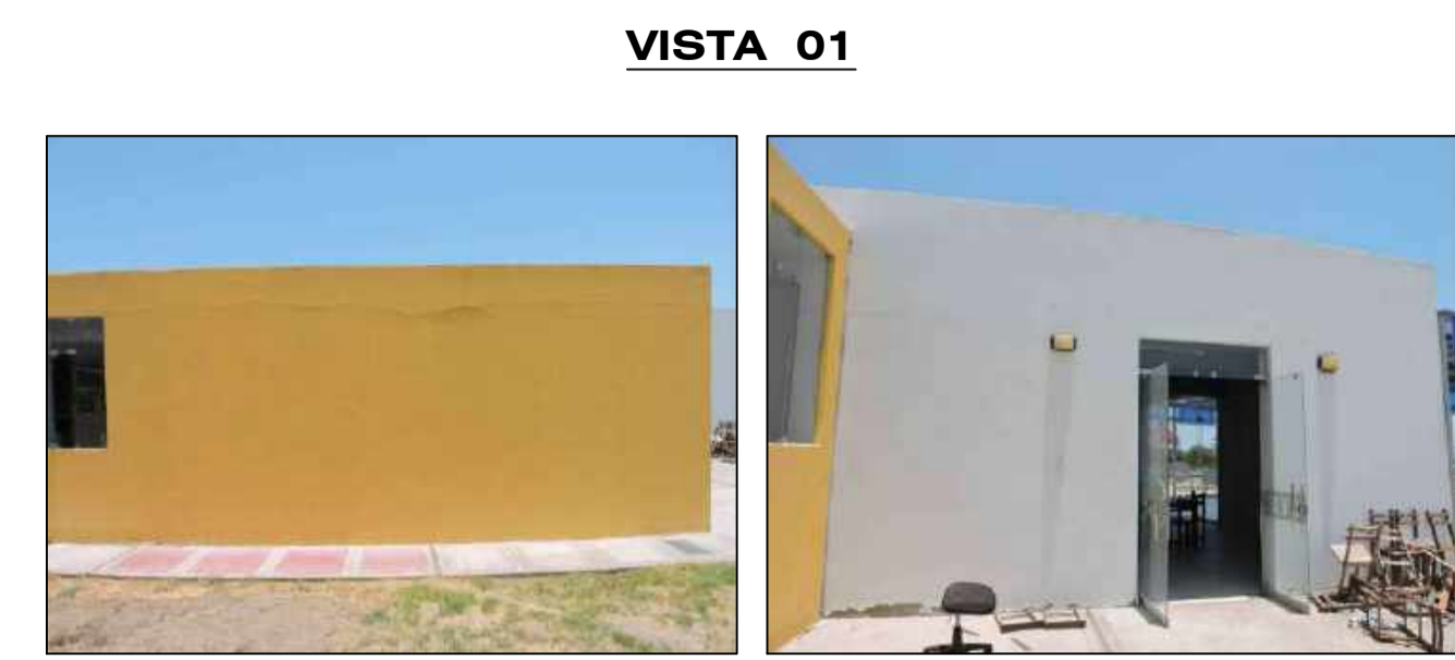
Fisuras longitudinales y transversales en los porticos ubicados en los EJES 1-1/2-2 entre EJE A-A/B-B'
