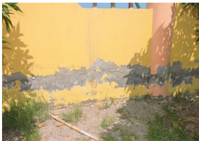
Figura 8. Eflorescencia en sobrecimiento
