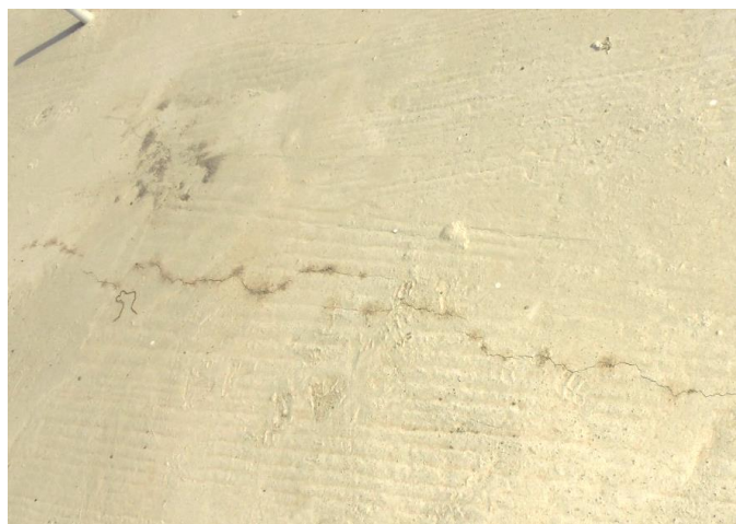
Figura 5. Fisuración en losa de concreto
