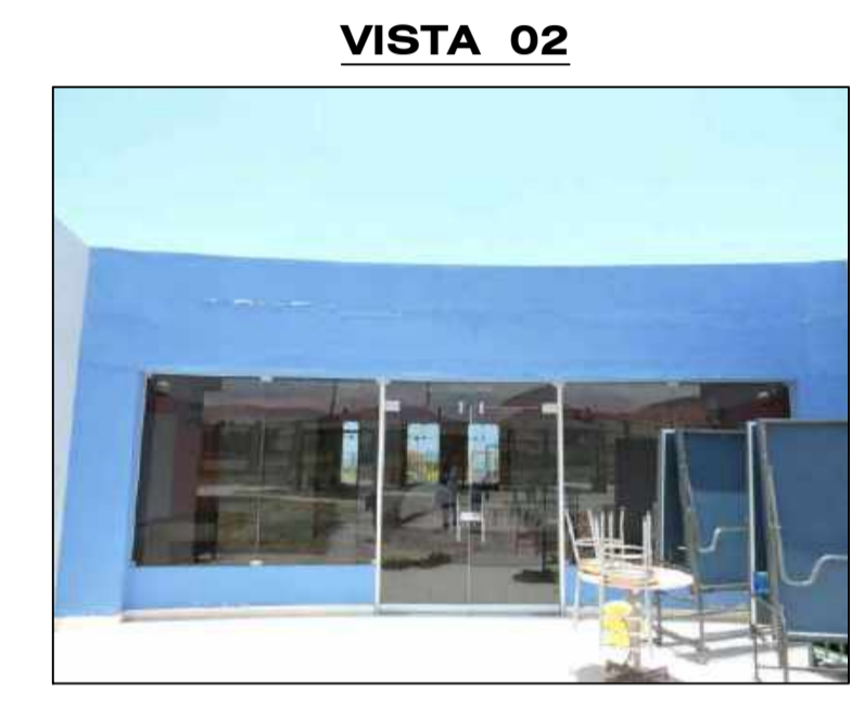
VISTA 02 Fisuras longitudinales y transversales de la parte exterior del salón de juegos en el EJE 4-4 entre EJE B'-D'
