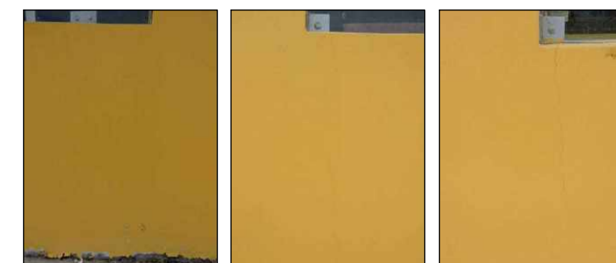
Fisuras transversales en el exterior del salón de juegos en el EJE 1-1 entre EJE C-D
