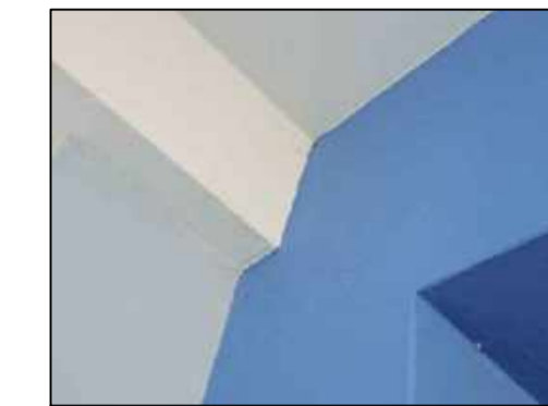
Fisuras longitudinales y transversales en el portico ubicado entre el EJE H-H/ EJE 4-4
