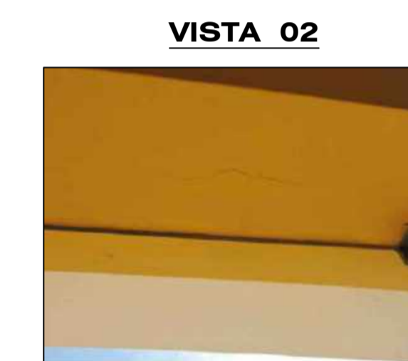
Fisura longitudinal en la viga EJE 5-5 entre EJE B-C
