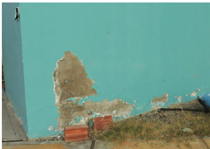
Figura 7. Humedad en muro de albañilería
