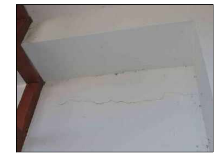
Fisura longitudinal frontal en la viga EJE 3-3 entre EJE C-D
