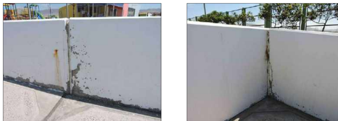
Fisuras, Desprendimiento y humedad en las veredas del complejo recreacional
