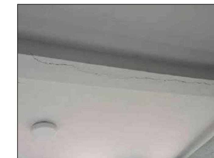
Fisuras longitudinales y transversales en el portico ubicado en el EJE 2-2 entre EJE B'-B''
