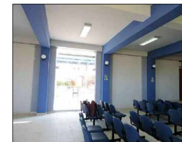
Fisuras longitudinales y transversales en el portico ubicado en el EJE 4-4 entre EJE G-K
