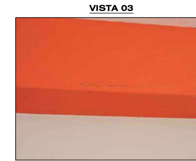
Fisura longitudinal inferior en la viga EJE 3-3 entre EJE B-C
