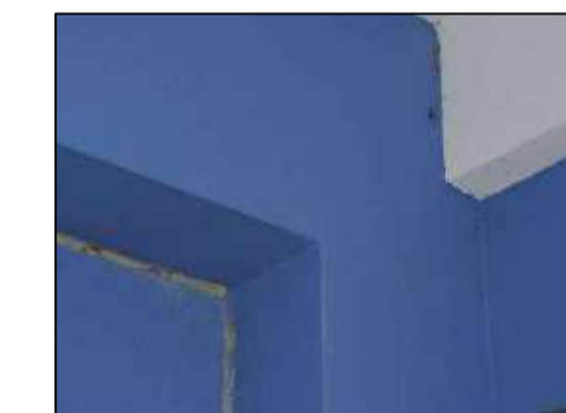
Fisuras longitudinales y transversales en el portico ubicado entre el EJE G-G/ EJE 2-2
