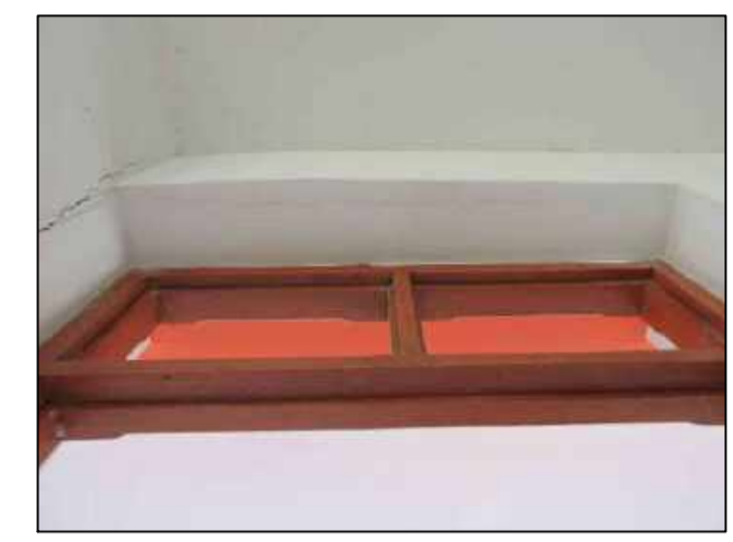
Fisura longitudinal frontal en la viga EJE 3-3 entre EJE C-D
