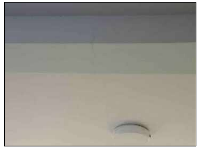
Fisuras transversales en la viga EJE 2-2 entre EJE C-D
