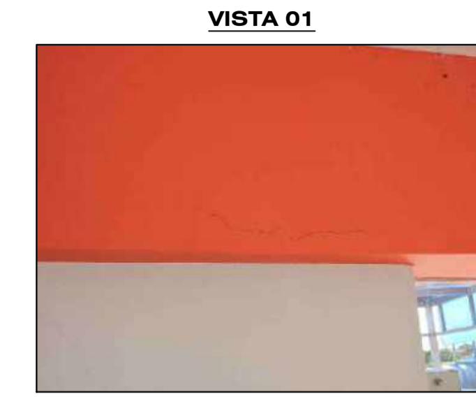
Fisura longitudinal inferior en la viga EJE 3-3 entre EJE F-G
