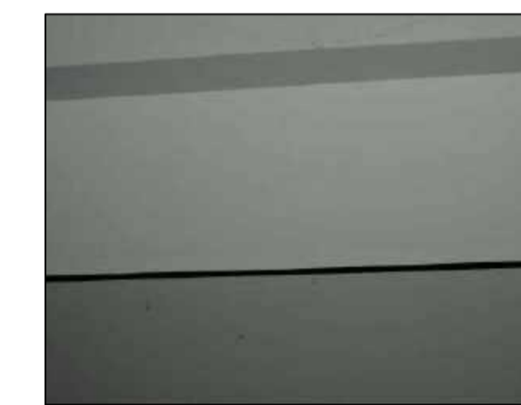
Fisuras longitudinales y transversales en el portico ubicado en el EJE G-H entre EJE G-H
