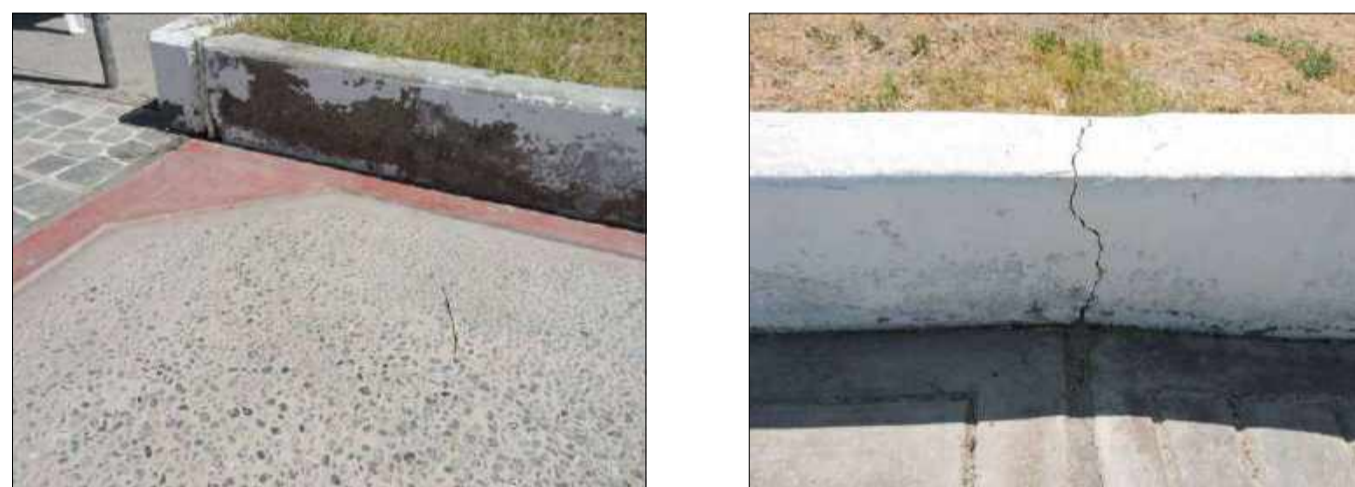
Fisuras, Desprendimiento y humedad en las veredas, sardineles y muros bajos del cerco perimetrico
