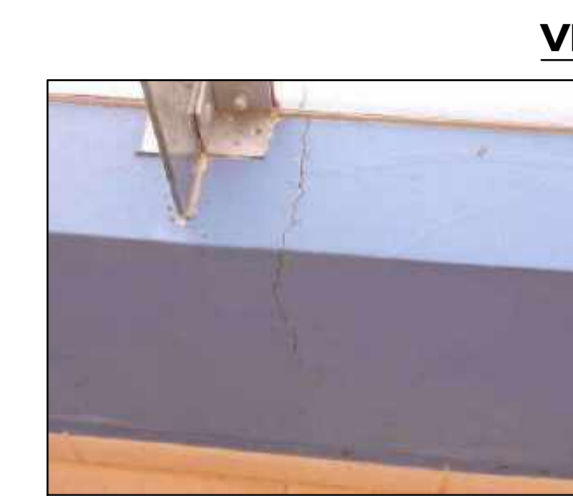
Fisura transversal en el sobrecimiento parte interna EJE 5-5 entre EJE A-B
