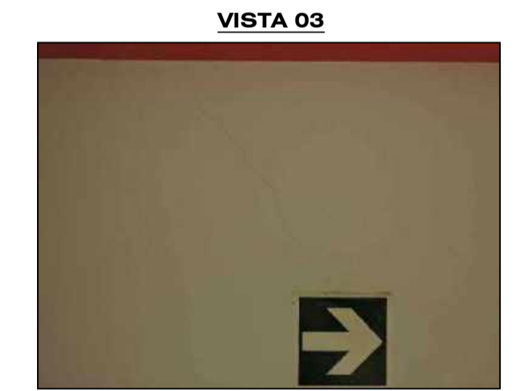
Fisura longitudinal inferior en la viga EJE 3-3 entre EJE A-B'
