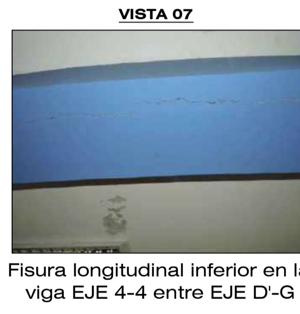
Fisura longitudinal inferior en la viga EJE 4-4 entre EJE D'-G
