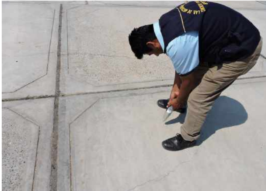
Fotografía 13. Resistencia de veredas en zona de piscina utilizando el esclerómetro
