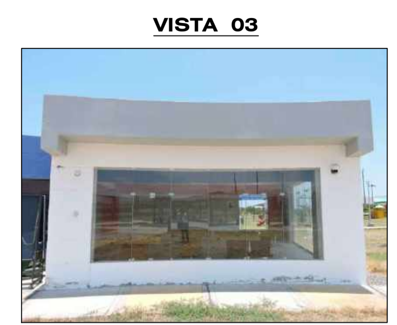
VISTA 03 Fisuras longitudinales y transversales de la parte exterior del salón de juegos en el EJE 5-5 entre EJE D'-G
