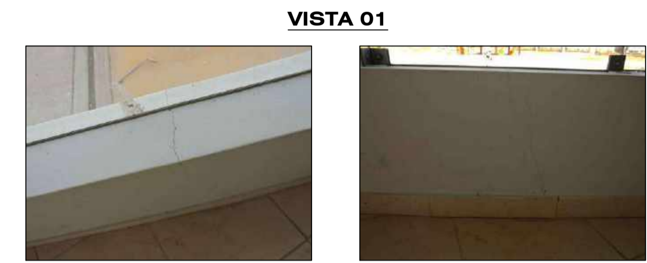
Fisura transversal frontal en el sobrecimiento EJE 5-5 entre EJE D'-G
