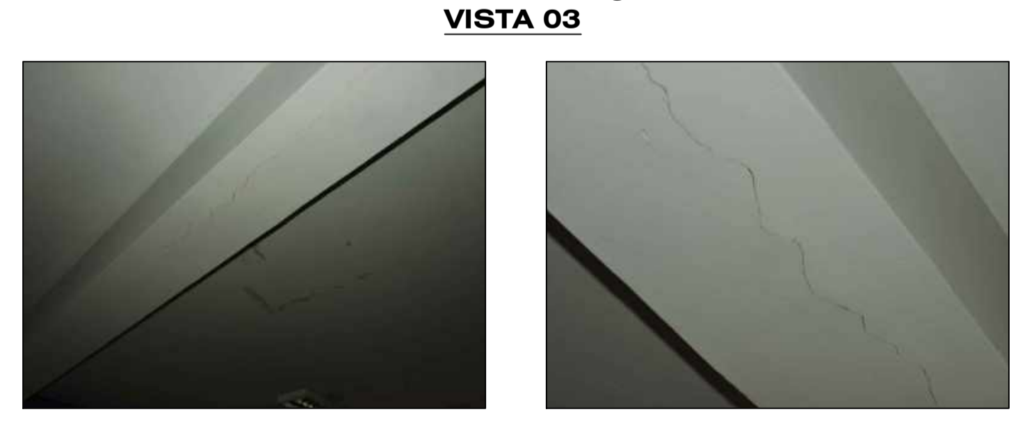
Fisuras transversales frontales en la viga EJE D'-D' entre EJE 3-4
