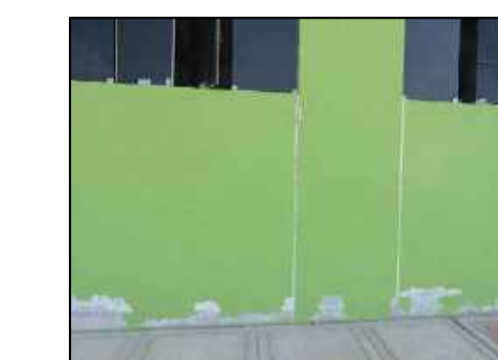
Detalle de descascamiento del material que recubre los sobrecimientos del ambiente en la parte exterior.
