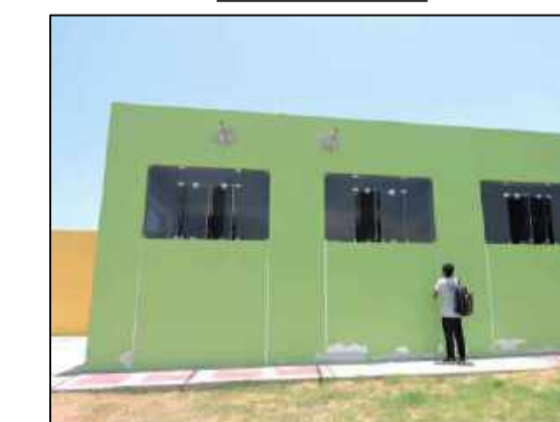
Fisuras longitudinales y transversales en el portico ubicado en el EJE 2-2 entre EJE K-G
