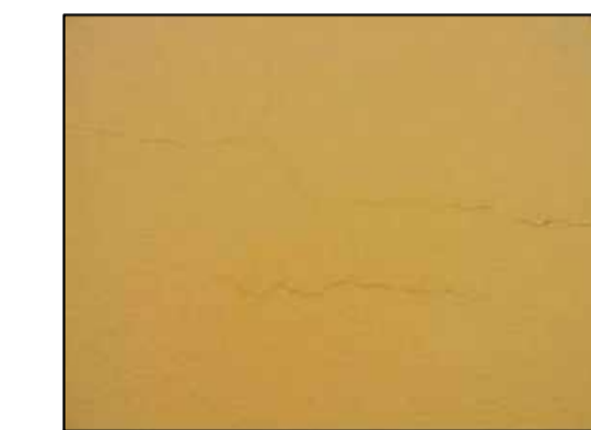
Fisuras longitudinales en el exterior del salón de juegos en el EJE 1-1 entre EJE B-C
