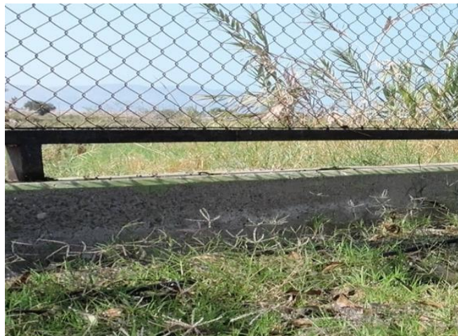
Figura 9. Descascaramiento del concreto en el sobrecimiento
