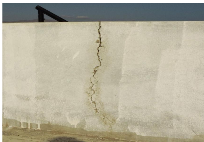
Figura 6. Agrietamiento en parapeto
