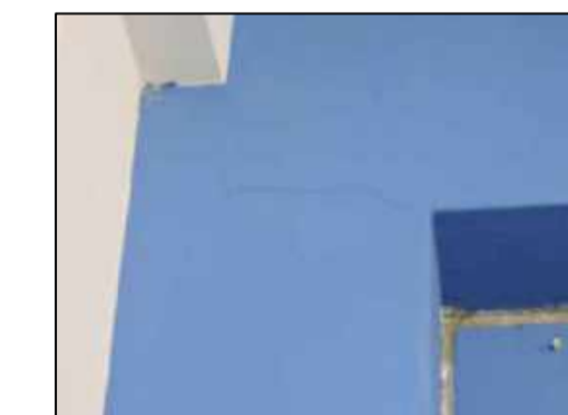
Fisuras longitudinales y transversales en el portico ubicado entre el EJE G-G/ EJE 4-4
