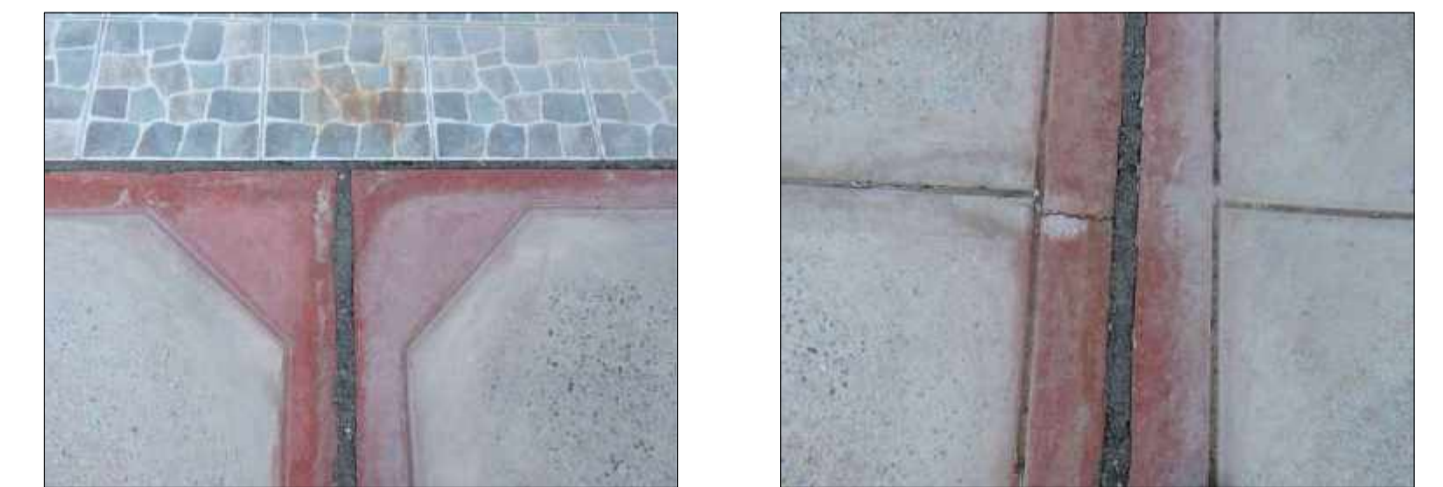
Fisuras, Desprendimiento y humedad en las veredas del complejo recreacional
