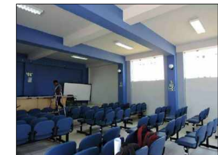
Fisuras longitudinales y transversales en el portico ubicado en el EJE 2-2 entre EJE G-I
