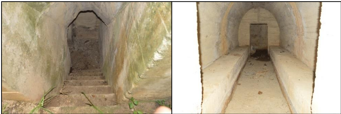
Gambar 4. Tangga Masuk Bunker (Kiri) dan Bagian dalam Bunker (Kanan) Sumber: Tim Survei Ekskavasi Universitas Halu Oleo dan Balar Sulsel, 2016.
