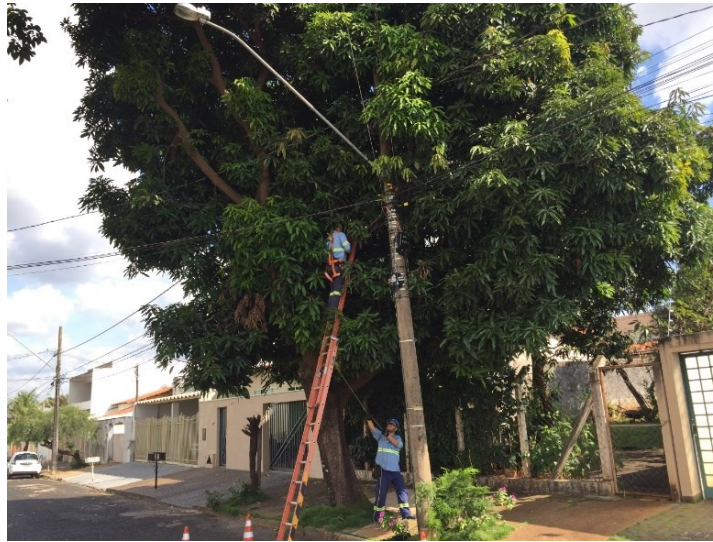
Figura 4. Árvore em conflito com rede elétrica no Setor B, bairro Cidade Jardim, Uberlândia, MG. Figure 4. Tree in conflict with power grid in Sector B, Cidade Jardim neighborhood, Uberlândia, MG.
