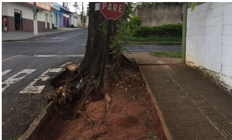
Figura 6. Árvore em conflito com calçada no Setor C, bairro Cidade Jardim, Uberlândia, MG. Figure 6. Tree in conflict with the sidewalk in Sector C, Cidade Jardim neighborhood, Uberlândia, MG.
