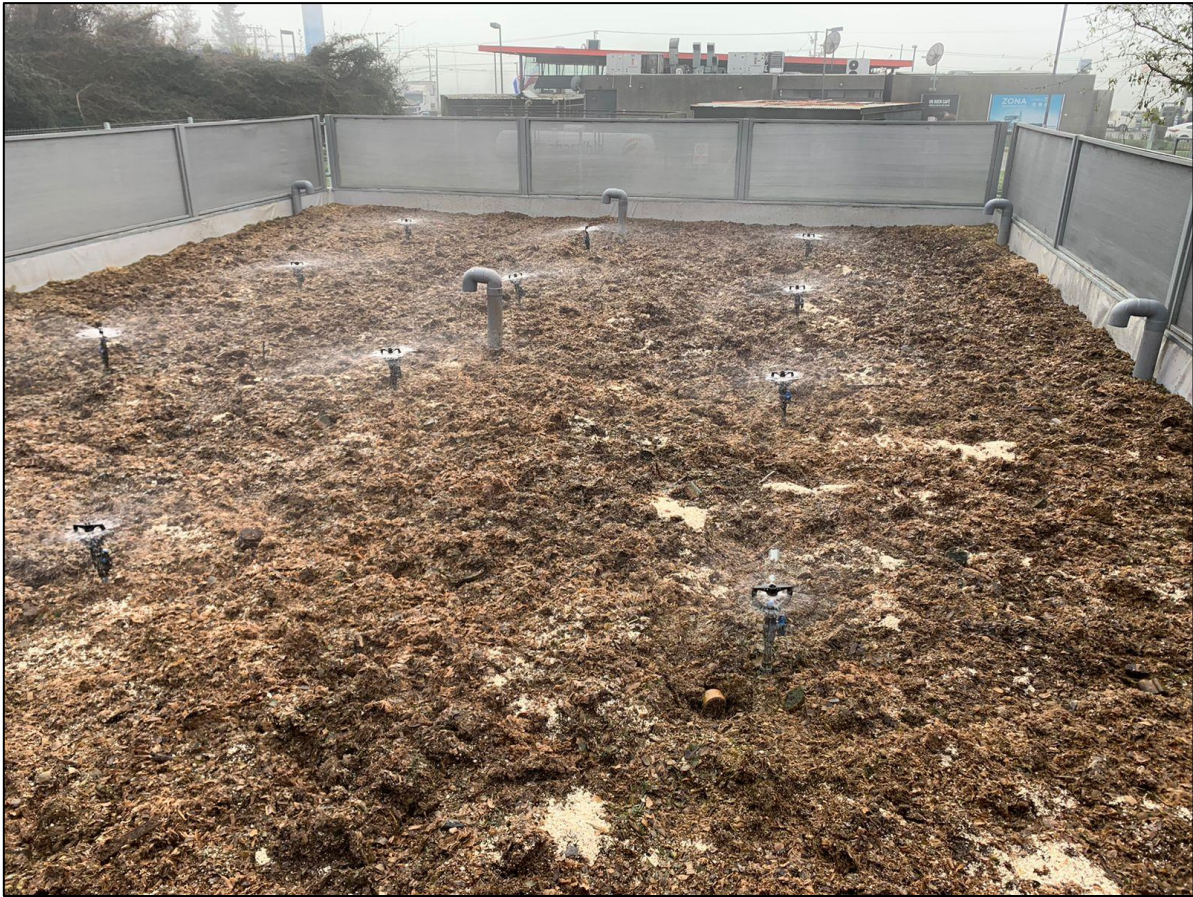
Figura 3-4. Lombrifiltro en Operación.
