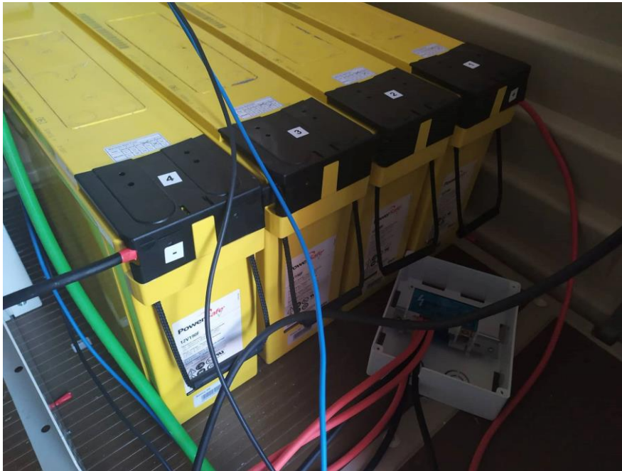
Figura 29: Baterías planta Helios.
