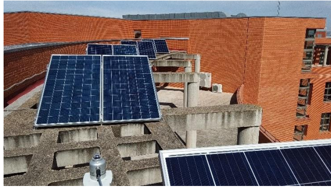
Figura 27: Paneles solares planta Helios.
