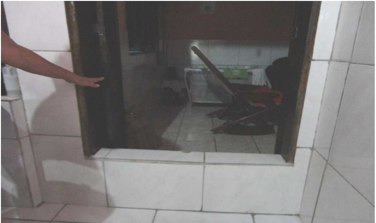
Figura 12 - Moradora indicando o nível alcançado pela água durante inundação ocorrida em 30 de março de 2009. Fonte: ABREU, 2015
