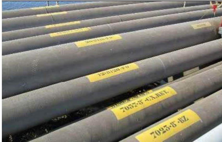
Ilustración 12 Conductos en lado izquierdo del tramo 1 de la pasarela de acceso (Fuente: imagen tomada en visita al muelle)
