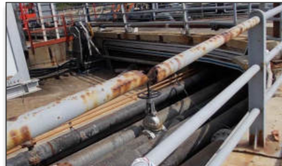
Ilustración 38: V1D: Barandilla dañada
