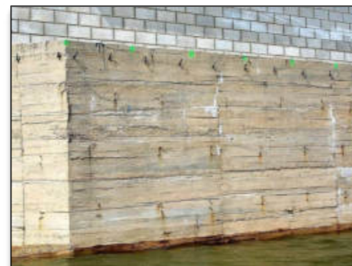
Ilustración 28: Duque de Alba 2: Presencia de alambres de encofrado y otros anclajes metálicos en desuso
