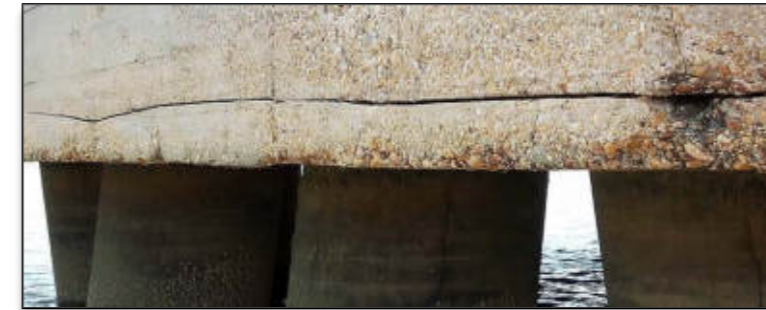
Ilustración 25: Duque de Alba 2. Discontinuidad entre capas de hormigonado, parte inferior
