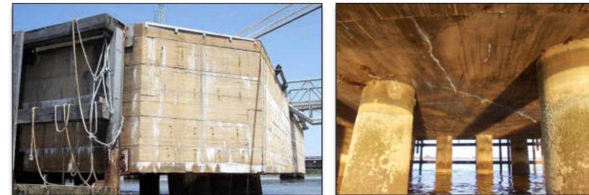
Ilustración 22: Duque de Alba 7. Presencia de múltiples tongadas y fisuras con presencia de carbonatos
