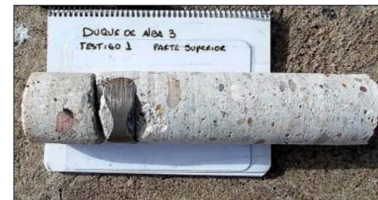
Ilustración 17: Estado de las armaduras en la extracción de testigo Duque de Alba 3, probeta T1 (losa parte superior)
