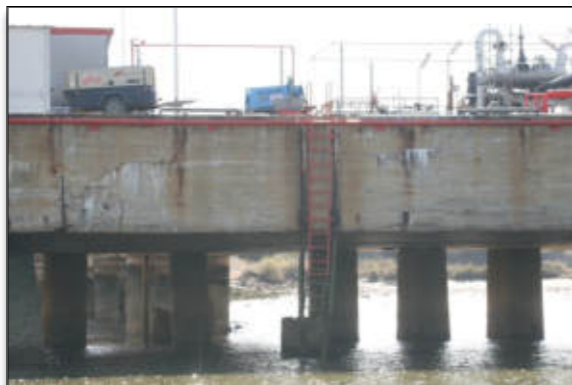
Ilustración 40: Resto de escala antigua deteriorada
