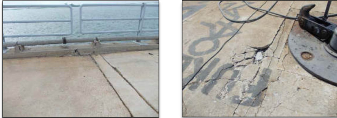
Ilustración 49: V1D-V2D: Rotura del HA soporte de tubería, junta y bordillo
