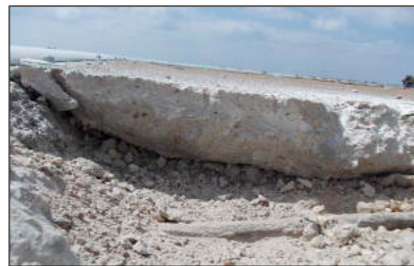
Ilustración 20: Discontinuidad en el hormigón
