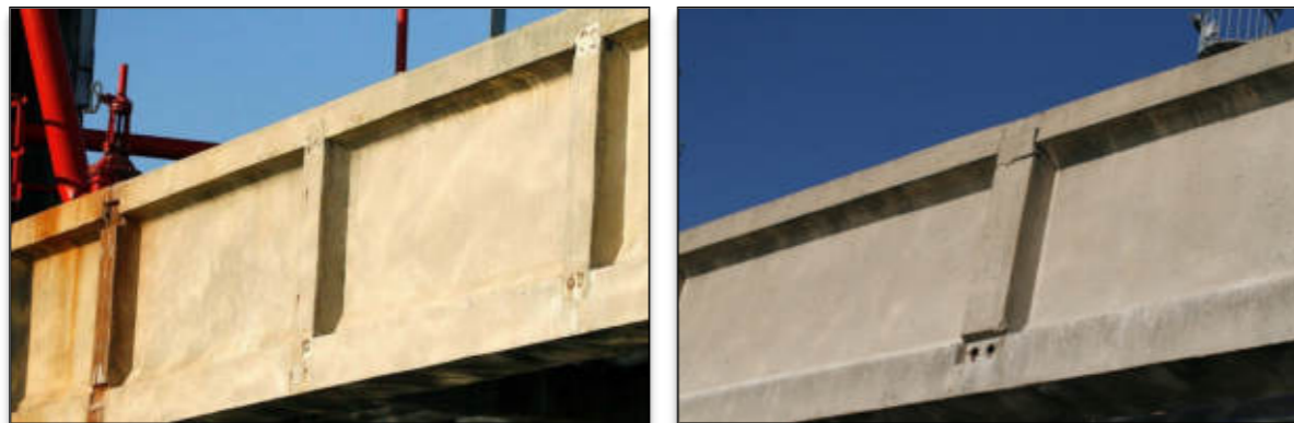
Ilustración 50: V1D: Ausencia de mortero de protección de cabezas de tesado
