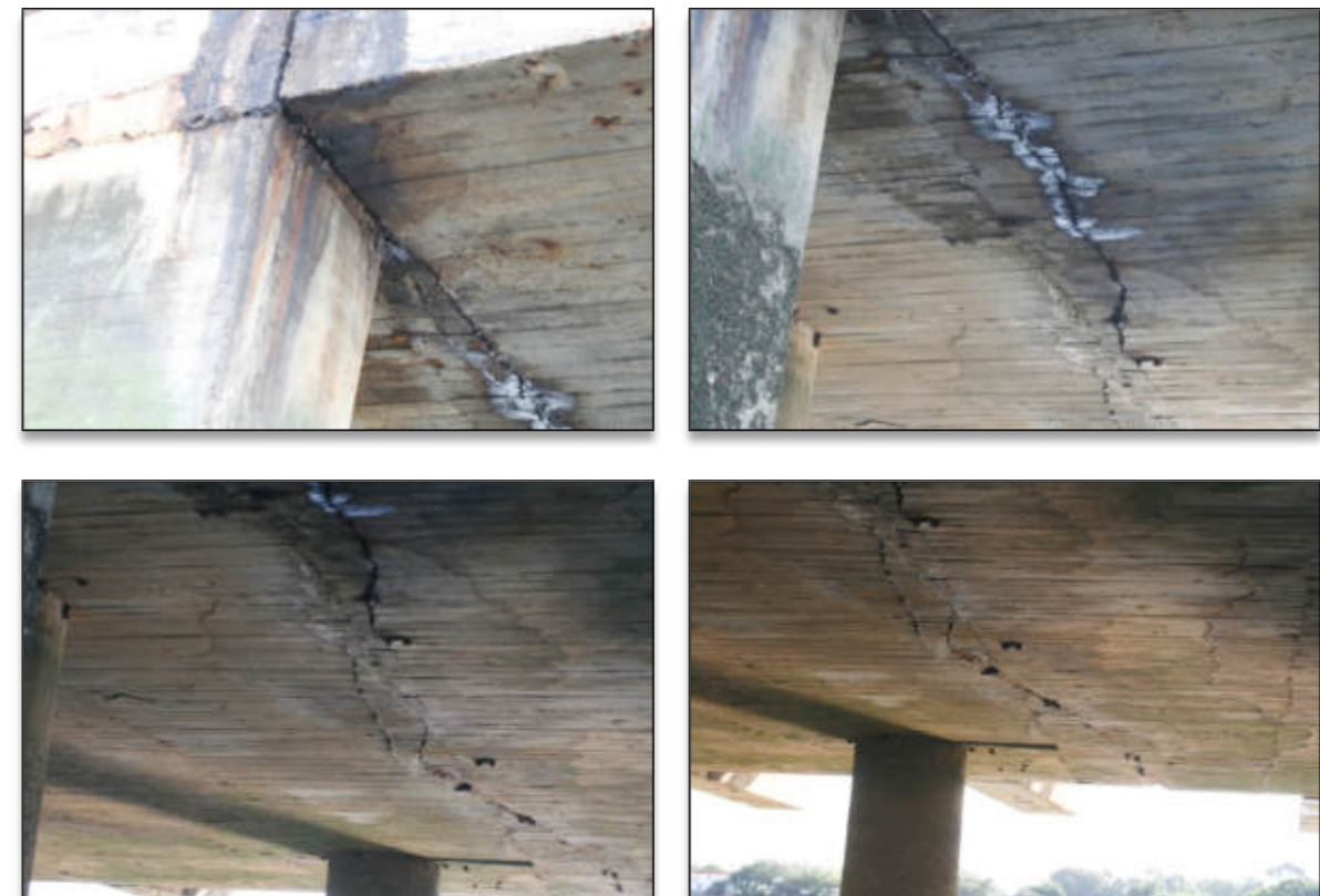
Ilustración 32: Diversas fotografías de la rotura de estructura del atraque I
