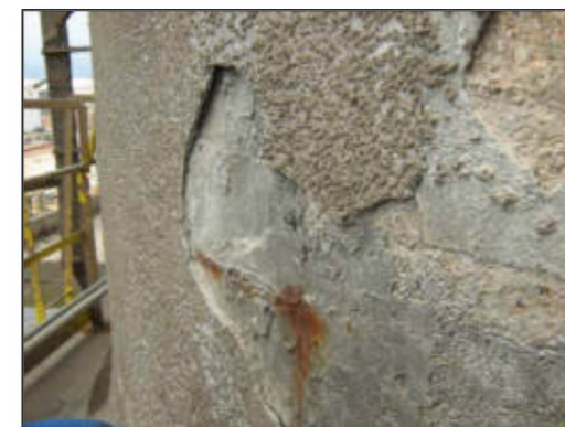
Ilustración 1 Proceso de corrosión en antiguos parches de reparación
