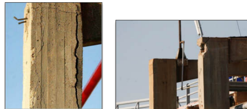
Ilustración 27: Atraque II: Rotura del hormigón por corrosión de los armados
