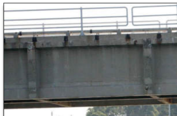
Ilustración 30: V1D: Presencia de placas metálicas de anclaje oxidadas.
