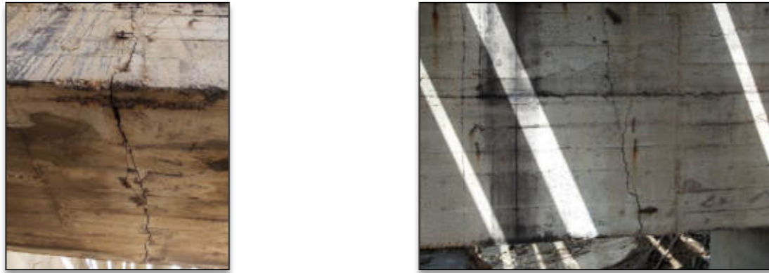
Ilustración 33: Pasarela Acceso: Presencia de importante fisuración en viga Pilar P1
