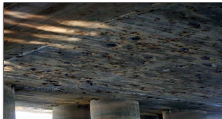
Ilustración 29: Macizo central: Presencia de abundante alambre de atado en el hormigón
