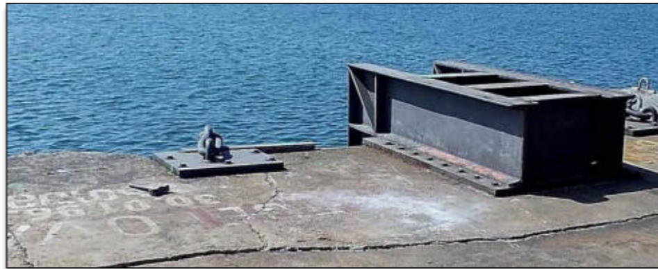
Ilustración 34: Atraque II: Fisuración coincidente con anclajes mecánicos de soportes de defensas
