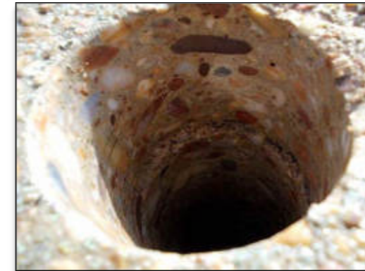
Ilustración 26: Duque de Alba 2: Despegue entre capas de hormigonado de losa
