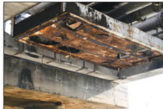
Ilustración 41: V7I Bandeja metálica deteriorada, a sustituir.
