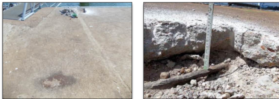
Ilustración 24: Duque de Alba 6. Discontinuidad entre capas de hormigonado
