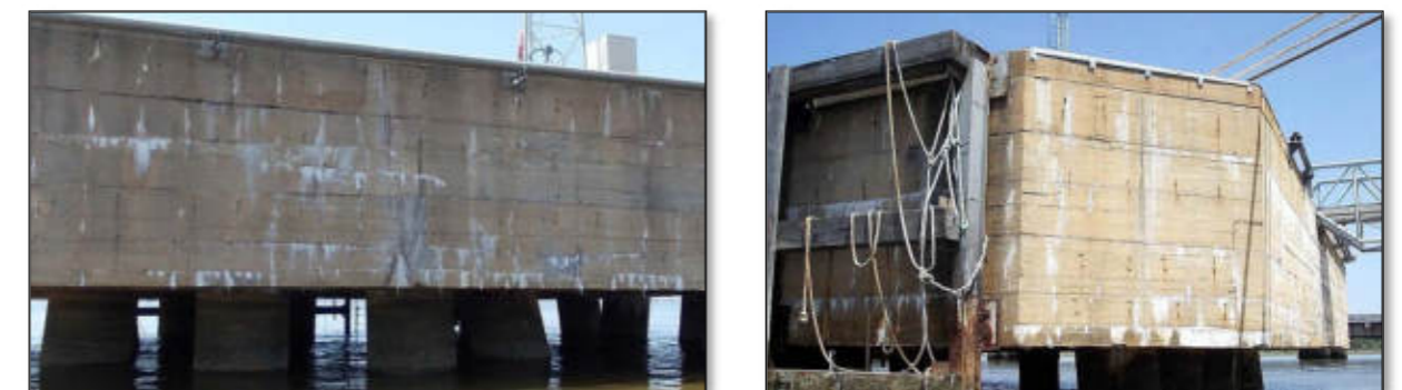
Ilustración 6: D. de Alba 7, Formación de eflorescencias debido al agua en circulación
