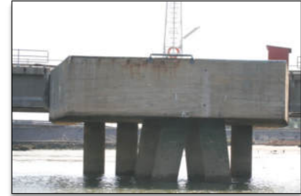
Ilustración 42: DA5 Cintón protección cabos amarre y rodillo
