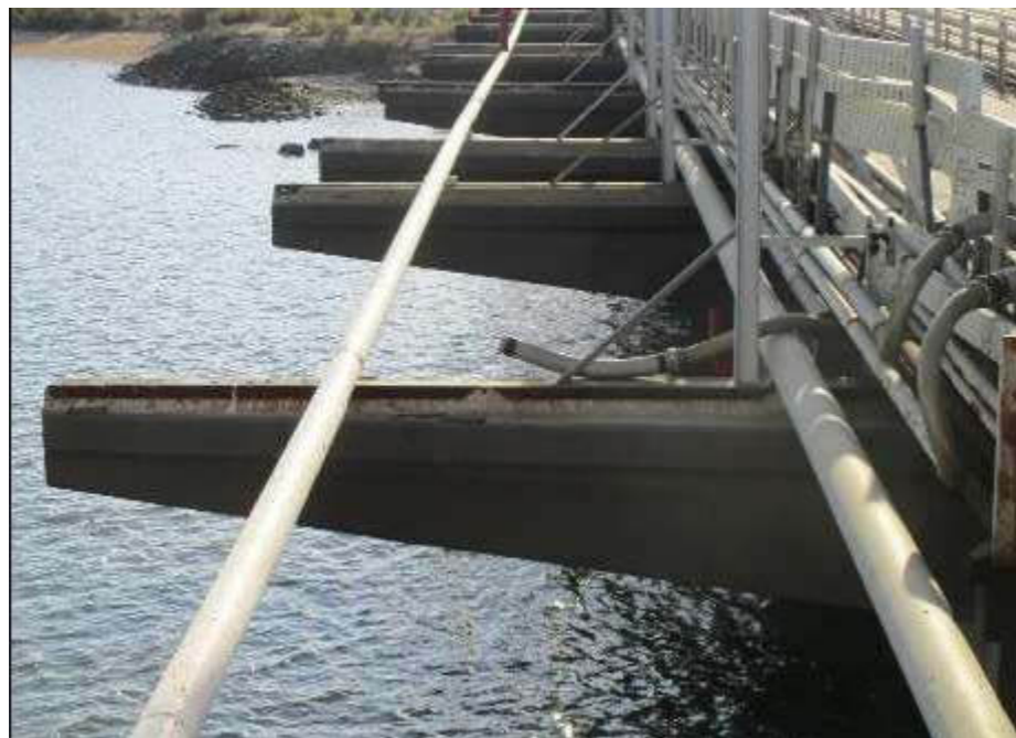
Ilustración 13 Conductos en lado derecho del tramo 1 de la pasarela de acceso (Fuente: imagen tomada en visita al muelle)
