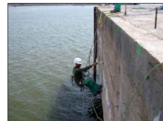
Ilustración 19: Medición de potenciales eléctricos en Duque de Alba 2, cara D (este)
