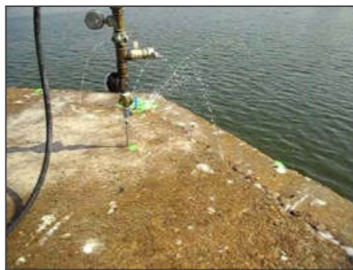
Ilustración 21: Flujo de agua a través de fisuras y junta de hormigonado superior
