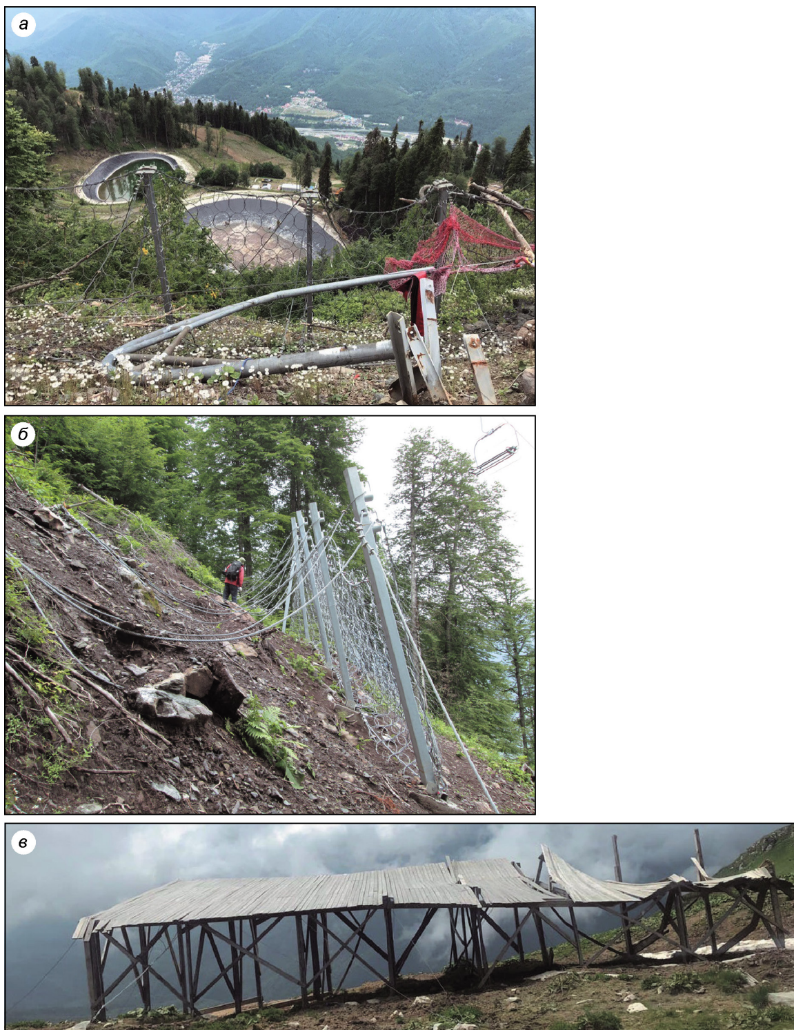
Рис. 3. Повреждённые инженерные противолавинные сооружения на территории горнолыжного курорта «Красная Поляна»:
