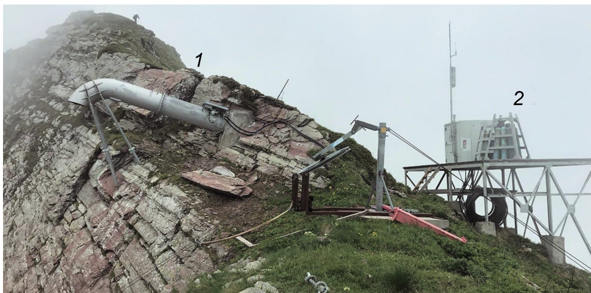
Рис. 2. Система искусственного сброса лавин Gazex®, установленная на территории горнолыжного курорта «Красная Поляна» (фото Д.И. Коровиной):
