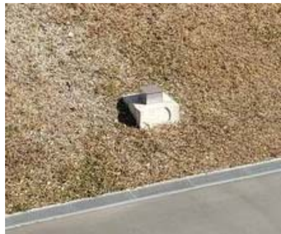
図5 建物周辺地盤の地震計の設置状況
