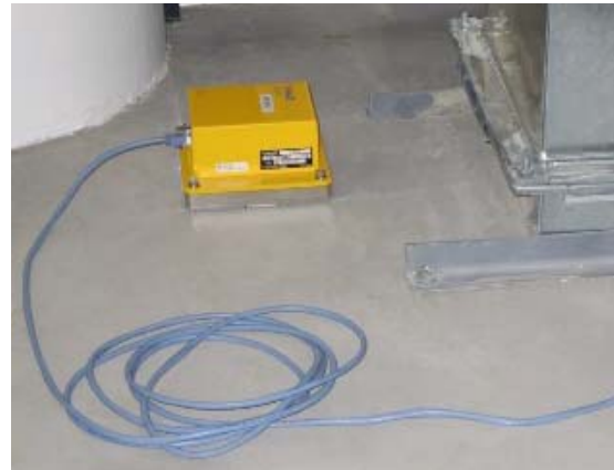
図4 建物内の地震計の設置状況
