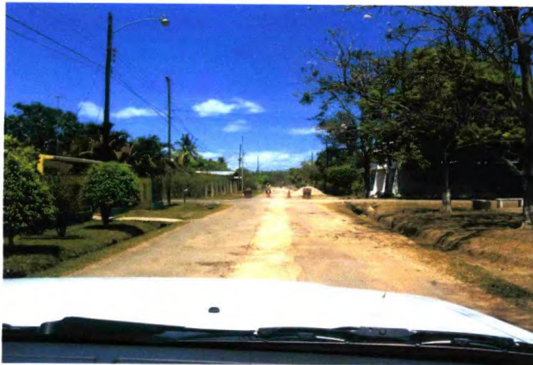
Muestra del mal estado de las calles de la ciudad de Natá.
