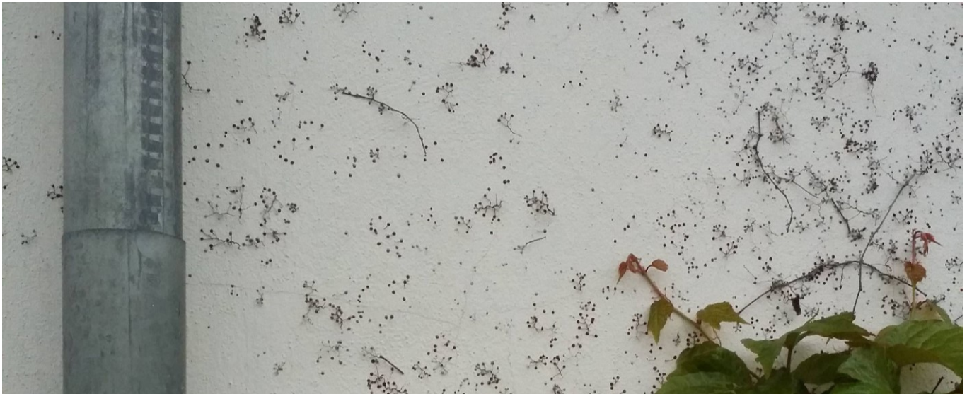
Abbildung 15 Rückstände nach dem Entfernen von Haftscheiben von Selbstklimmern; StadtLand GmbH 2021
