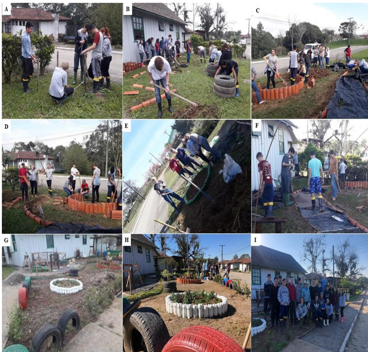
A: mediação da área; B: alocação do caminho; C e D: construção do canteiro central com telhas usadas e colocação da lona no caminho (piso podotátil); E: construção do canteiro com garrafas pet; F: colocação dos diferentes materiais no piso podotátil; G: visão geral do jardim sensorial em construção; H: Visão geral do jardim após o término dos canteiros, piso podotátil e colocação dos pneus; e I: Estudantes do Curso Técnico em Agropecuária Integrado ao Ensino Médio/IFC – Campus Rio do Sul. Fonte: Acervo do projeto, 2019.
