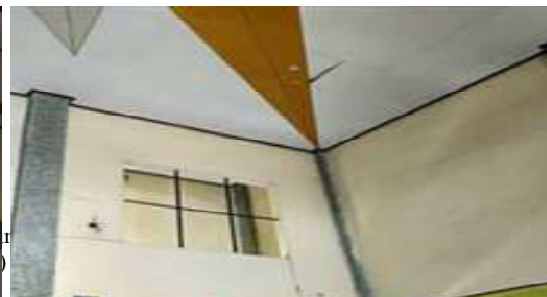
Gambar 3. Ventilasi yang letaknya di atas, ada 4 buah.
