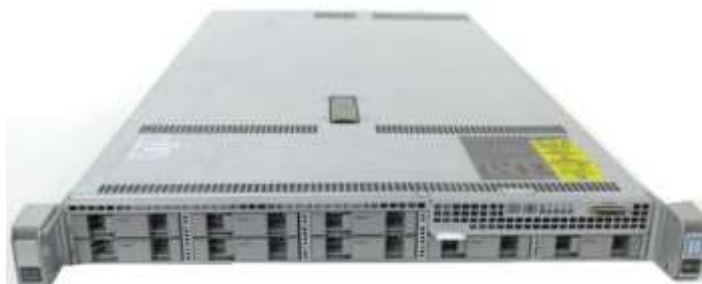
Figura 6. 6 Servidor Instalado DNA Center
