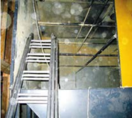
Kuva 1. Pelastuslaitoksen tekemä aukko siilon kylkeen (YTOT 3/08).
