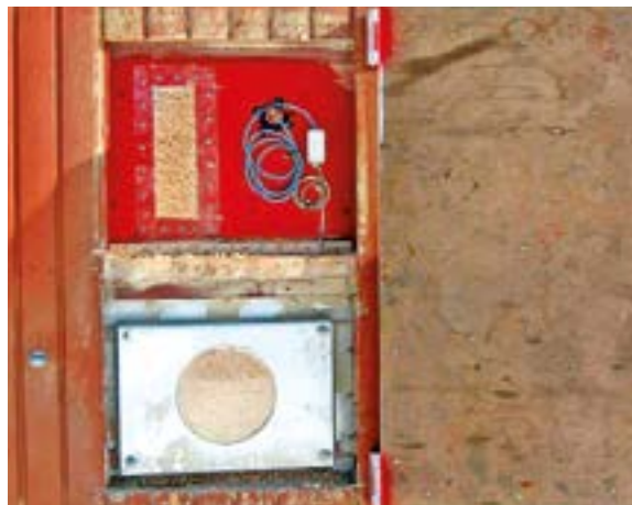
Kuva 5. Tapaturman jälkeen pelastustyön aikana tehtyyn aukkoon rakennettiin siilon huoltoluukku sekä ikkuna pelletin määrän tarkkailuun. Lisäksi asennettu pintavahti (johdot) (YTOT 2/08).
