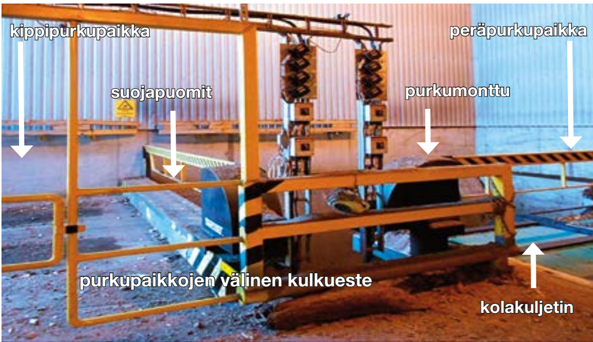
Kuva 9. Suojapuomit, jotka kiinni mennessään kytkevät pois päältä purkumontun pohjalla olevan kuljettimen. Lisäksi vasemmalla hyvä esimerkki siitä, miten kulkemista voidaan rajoittaa ja ohjata tiloissa (TOT 4/10).
