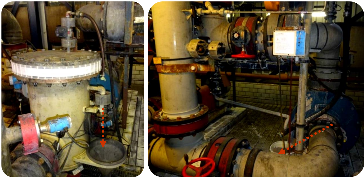
Abbildung 29: Probenahme Quenche (links), Probenahme der Füllkörperstufe 1 (rechts).
