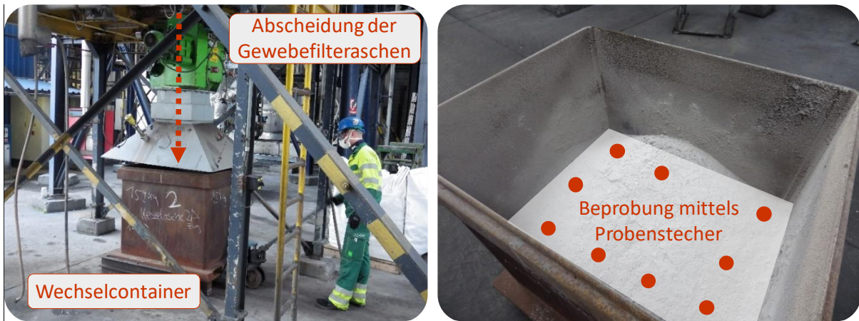
Abbildung 27: Behälter zur Erfassung der Kesselaschen 2./3. Zug (links), Blick in Behälter (rechts).
