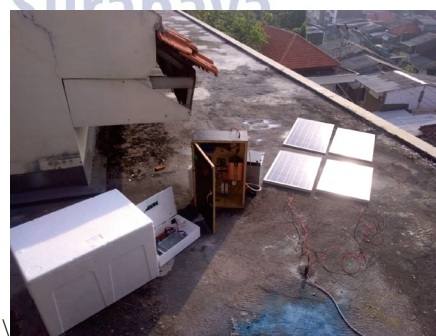
Gambar 3. Pengujian penggunaan PLTS
