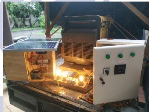
Gambar 8. Menunjukkan bahwasanya sumber daya utama (PLN) mengalami gangguan kemudian beban disuplai oleh PLTS ( Pembangkit Listrik Tenaga Surya )
