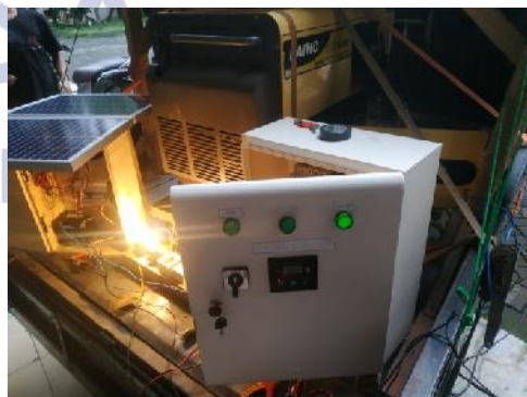
Gambar 9. Menunjukkan bahwasannya Genset sudah mampu menyuplai beban
