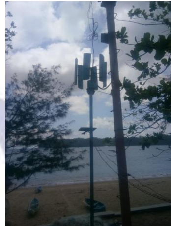
Gambar 2. Pembangkit Listrik Hybrid Turbin Angin Darrieus dan Solar PV
