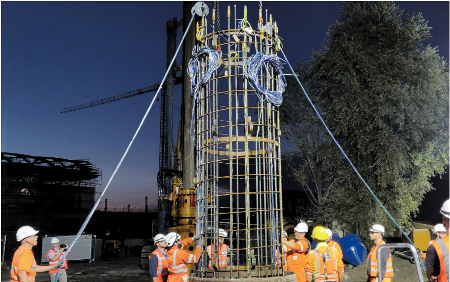
Abbildung 15: Kabelführung beim Korbeinbau
