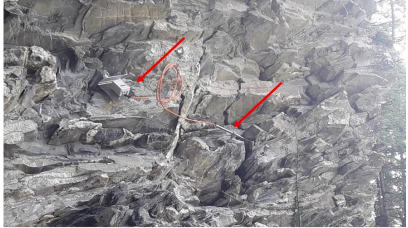
Abbildung 16: Montierte Mini-Node und Telejointmeter
