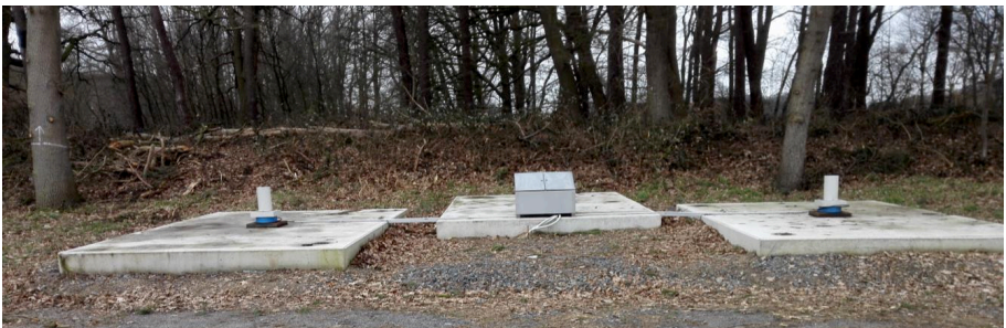
Abbildung 4: Anker FA1 bis FA3 im eingebauten Zustand mit Betonwiderlager, Messstation, Kraftmessdosen (blau) und Schutzkappe (weiß)
