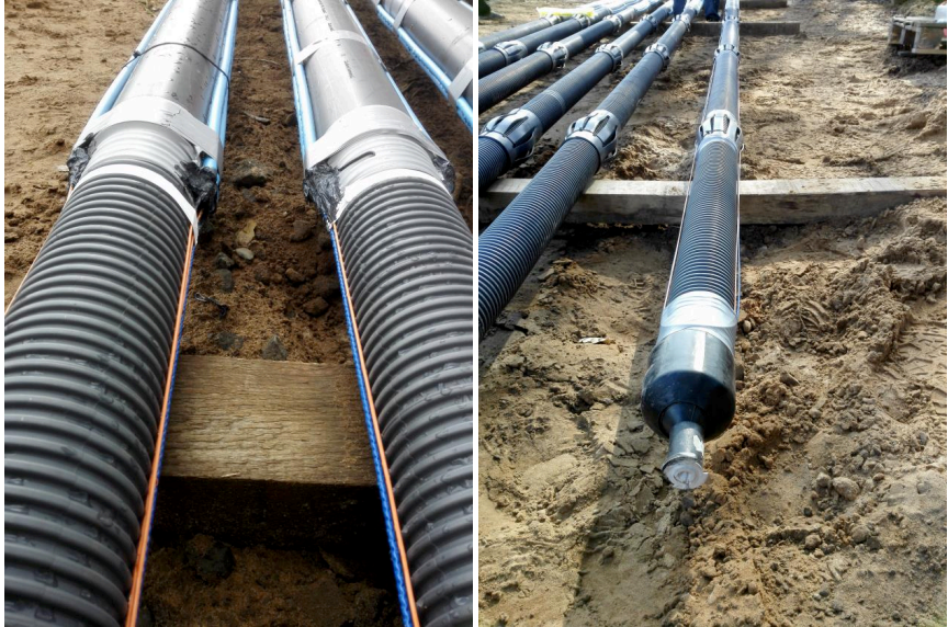
Abbildung 3: Angebrachte Glasfaserkabel vor dem Einbau des Einstabankers im Übergangsbereich zwischen Ripprohr und Glattrohr (links) und im Fußbereich (rechts)
