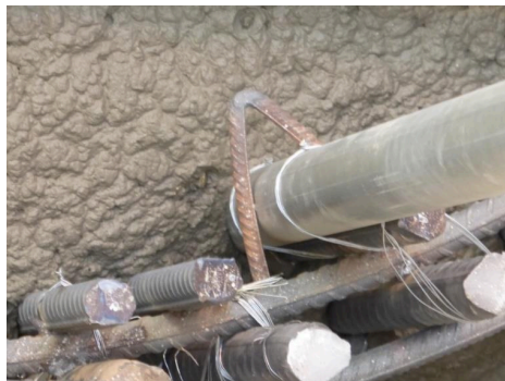
Abbildung 2: Ein CSL-Messrohr in einem Bewehrungskorb kann den Betonfluss behindern
