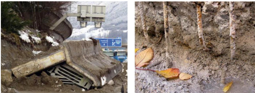
Abbildung 1: Korrosionsschäden an Winkelstützmauern; Links: Versagen einer Spornmauer an der Brennerautobahn [Kirchmair, 2017]; Rechts: Korrosionsschäden im Bereich der erdseitigen Arbeitsfuge [GUMA, 2014]
