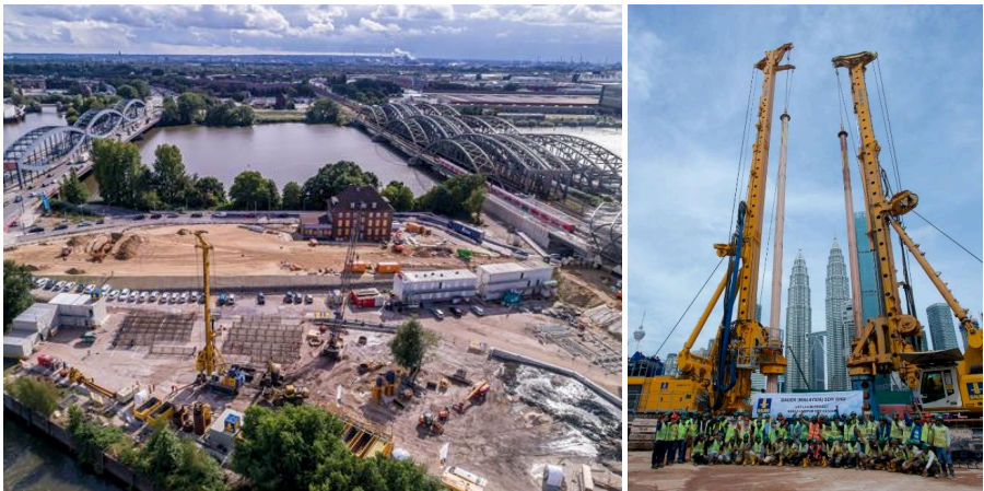
Abbildung 1: Bohrarbeiten für tiefe Pfähle in Hamburg (links) und in Kuala Lumpur (rechts)
