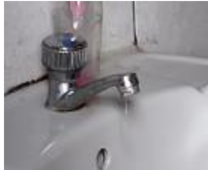
Figura 27: Goteo de agua en el baño para discapacitados
