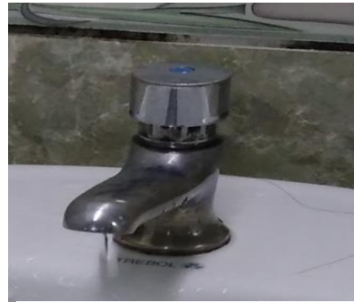
Figura 29: Goteo de agua en el baño principal para damas del primer piso
