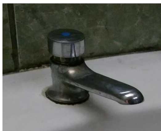
Figura 22: Temporizador en baño de damas cerca de auditorio (Ad. M)
