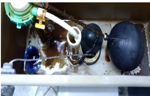
Figura 30: Fuga de agua desde la tapa de la caja del inodoro, baño principal de damas del primer piso
