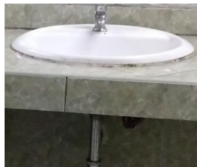
Figura 31: Goteo desde la tubería inferior a grifo, baño principal de damas del primer piso
