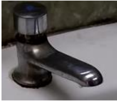
Figura 26: Goteo de agua en el baño de damas, a la entrada del auditorio
