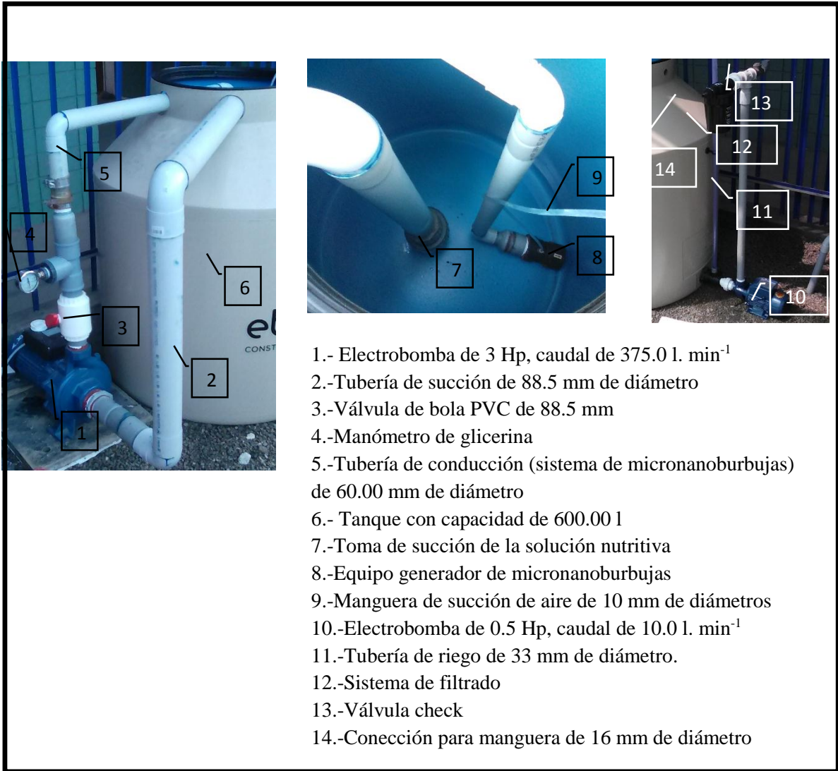
Figura 5: Instalación del tanque de solución nutritiva y el sistema generador de MNB
