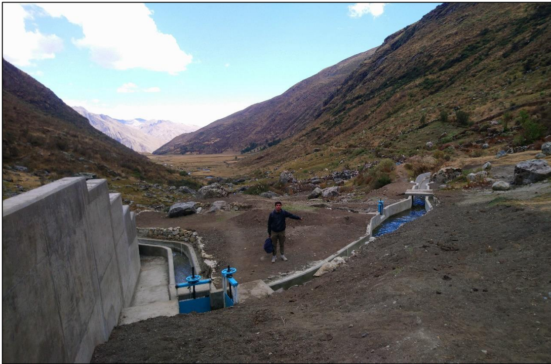
Figura 64: Salida de captación de la Bocatoma hacia el desarenador
