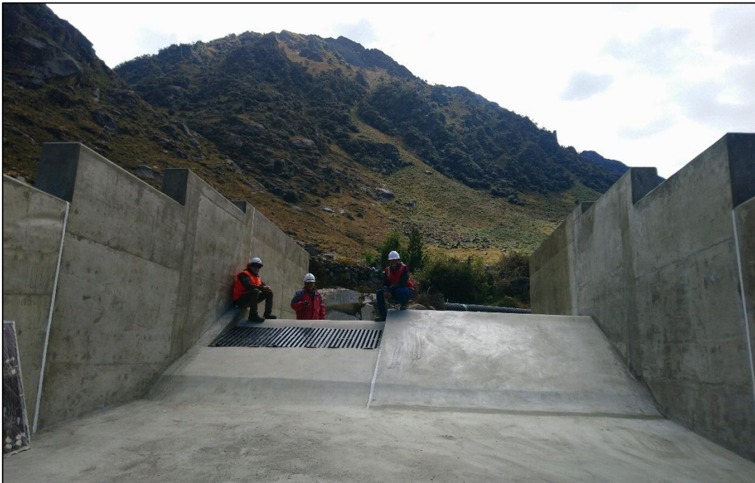
Figura 60: Barraje y rejilla de captación de Bocatoma, sin funcionamiento
