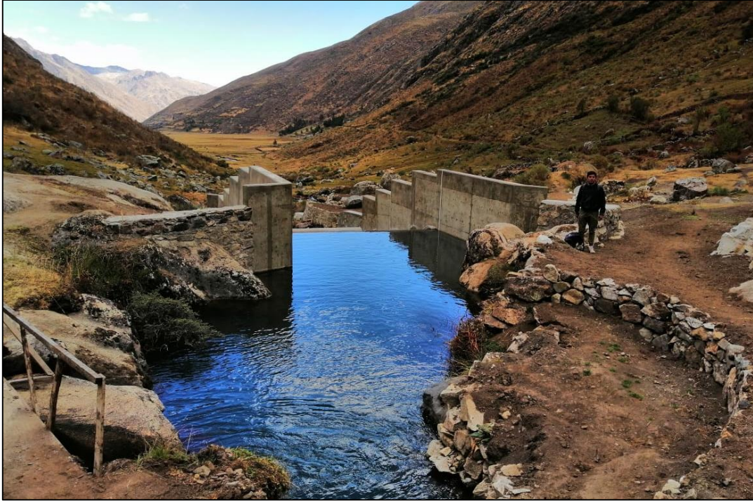
Figura 59: Vista aguas abajo de Bocatoma tipo tirolesa en funcionamiento
